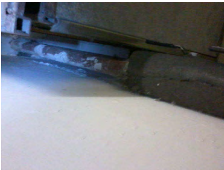
Falta aislante circuito de calefacción, patinillo PB del atrio.
