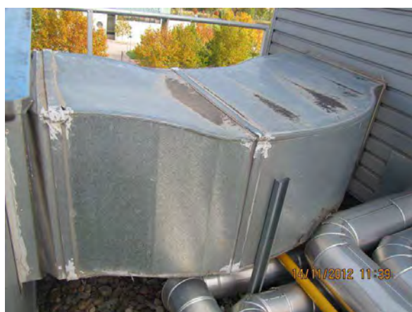
Conducto de impulsión sin aislar. UTA 3.
