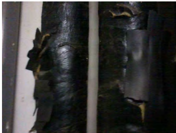
Parches del aislante se están despegando. Circuito UTA1 y UTA 2. Patinillo de física y química PB.
