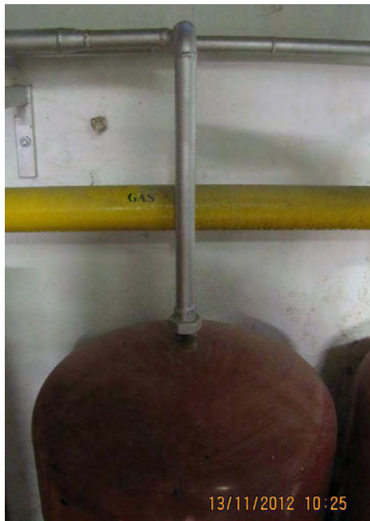
Deposito de expansión del CCTO primario. Sala de calderas.
