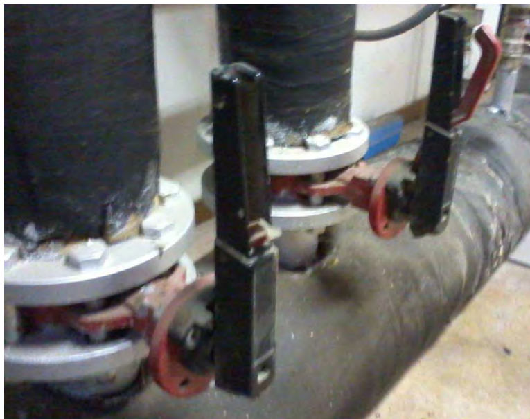
Palanca de una válvula rota, situada en sala de bombas.
