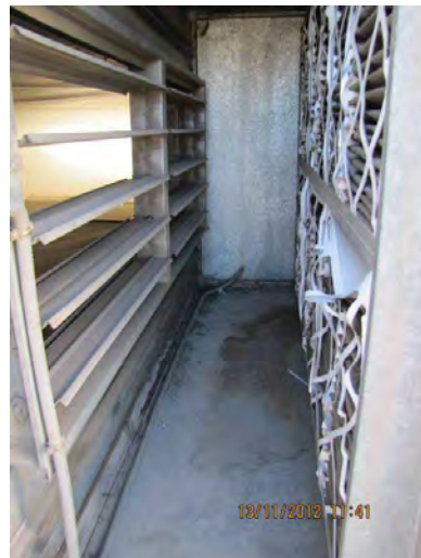
Filtro en la entrada de aire. UTA 1.
