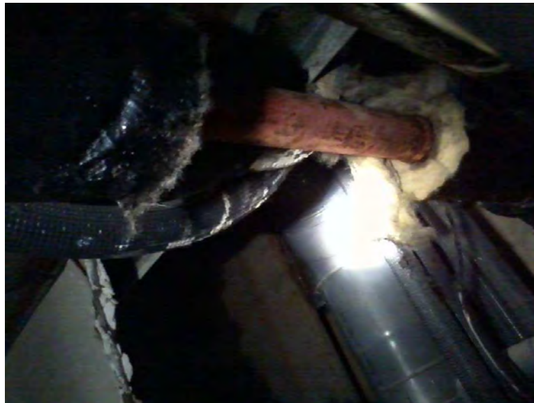
Circuito UTA 8, falta aislante, falso techo aula informática P1.
