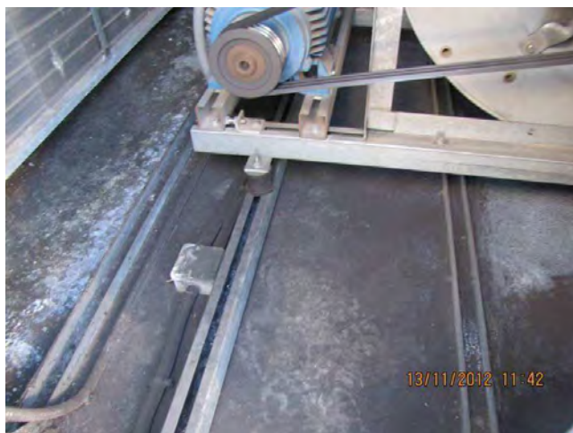
Ventilador de aire. UTA 1.
