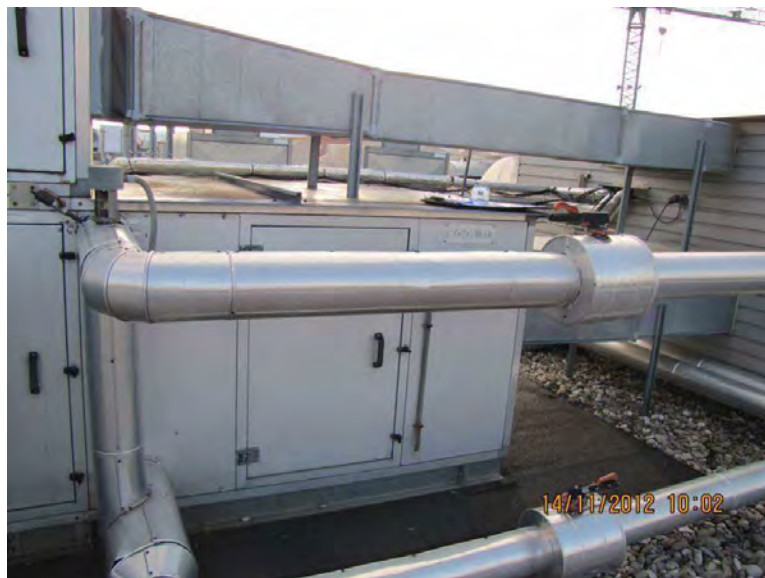
UTA 4 y conductos de impulsión y retorno sin aislar.
