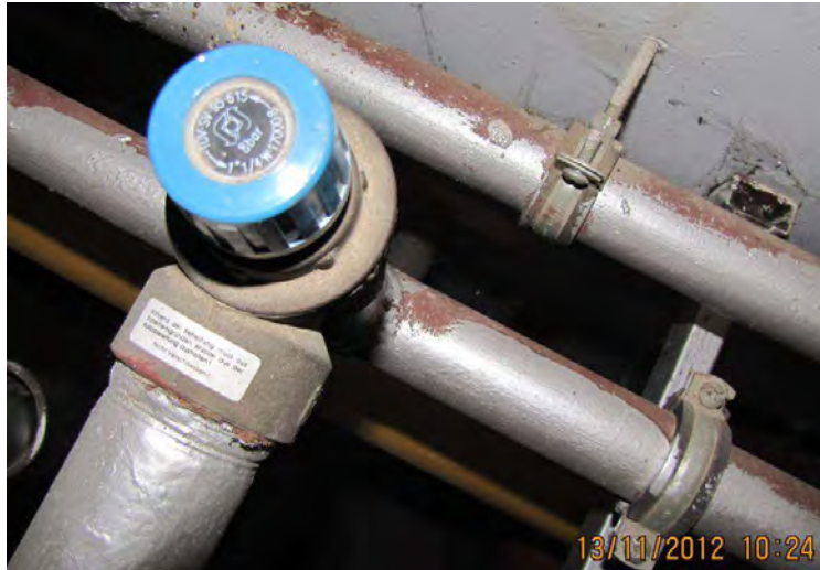
Válvula de seguridad de 8 bar del circuito primario. Sala de calderas
