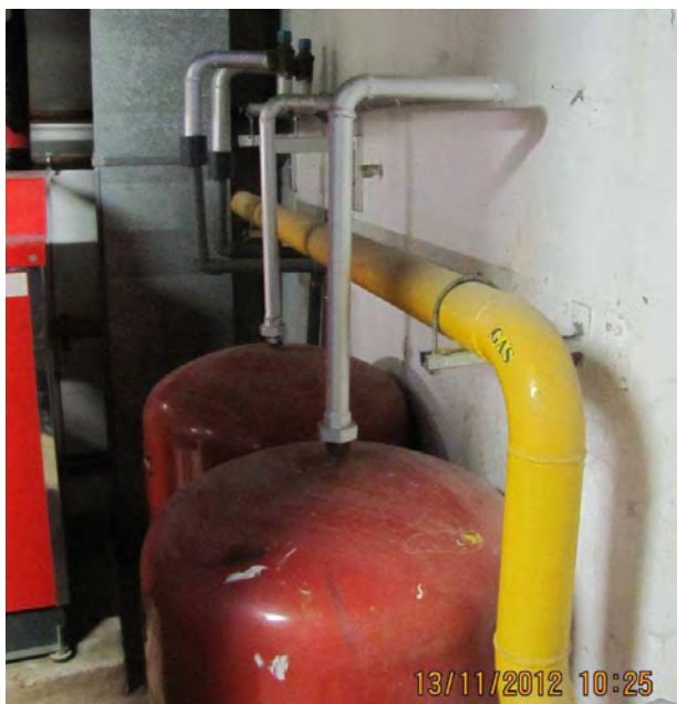
Depósitos de expansión del CCTO primario. Sala de calderas.
