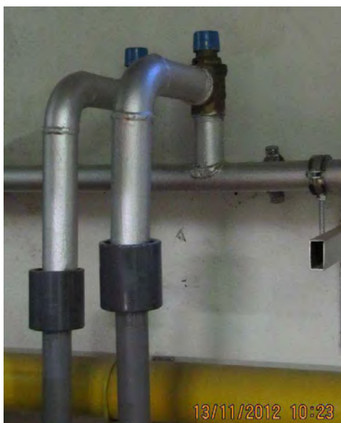
Válvulas de seguridad del circuito de ACS. Sala de calderas
