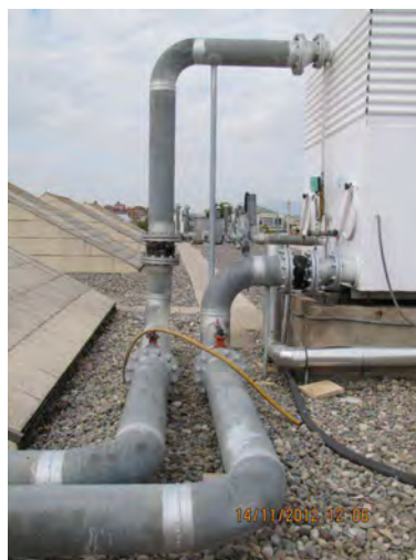
Conductos de los Grupos de Absorción a la torre. Sin aislar
