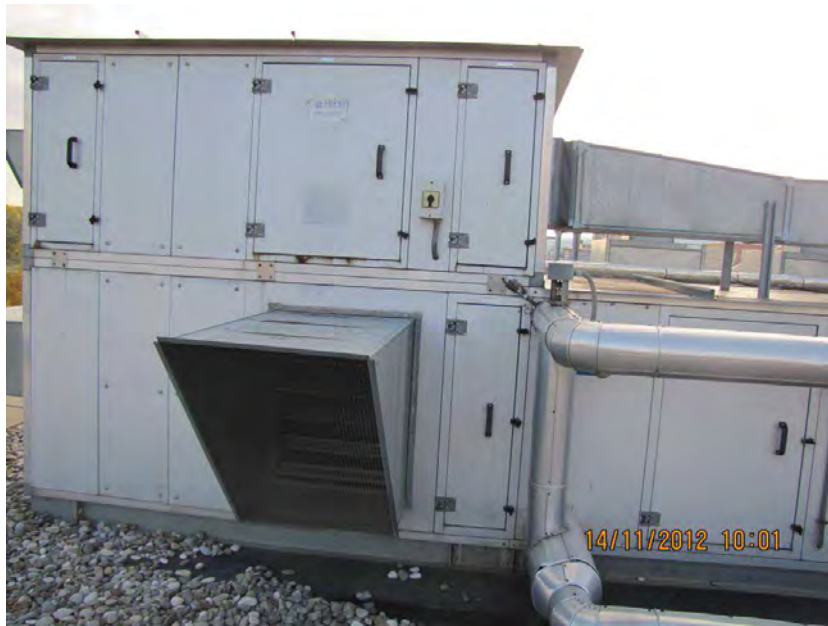
UTA 4. Zona cubierta.
