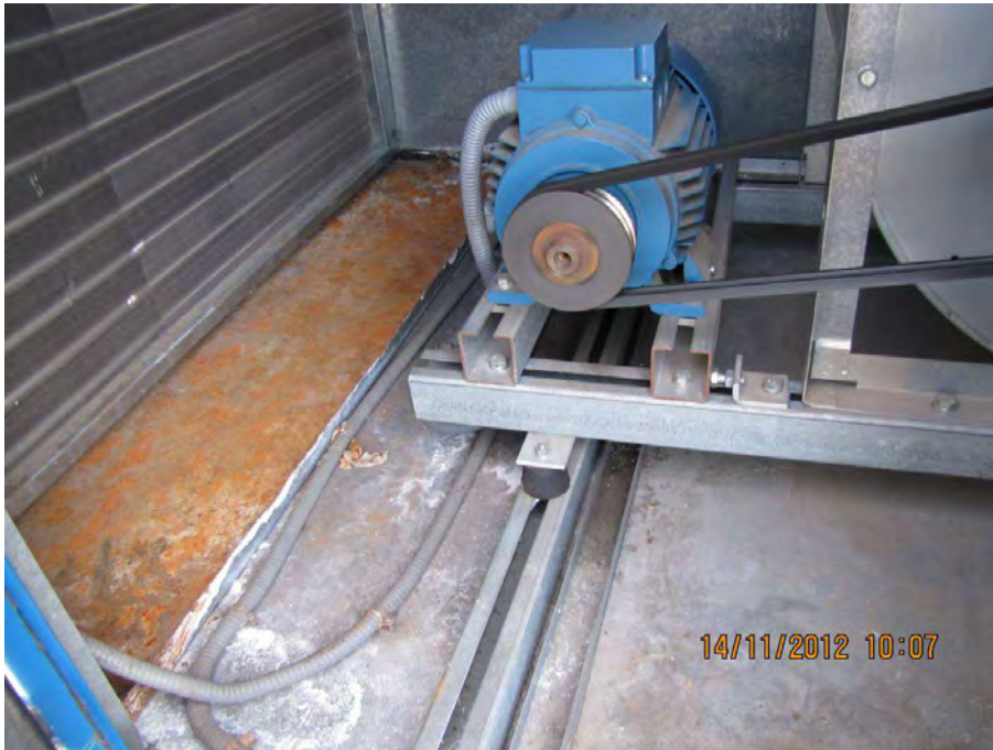
Ventilador inferior. UTA 4.
