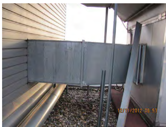
Conducto de impulsión sin aislar. UTA 5.
