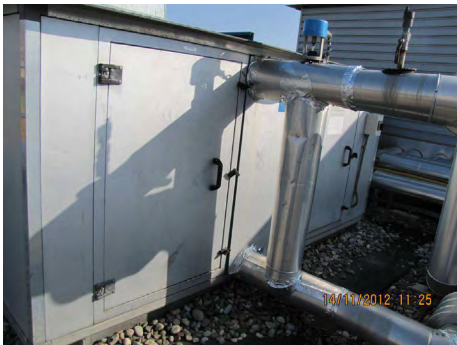
UTA 3, zona cubierta.
