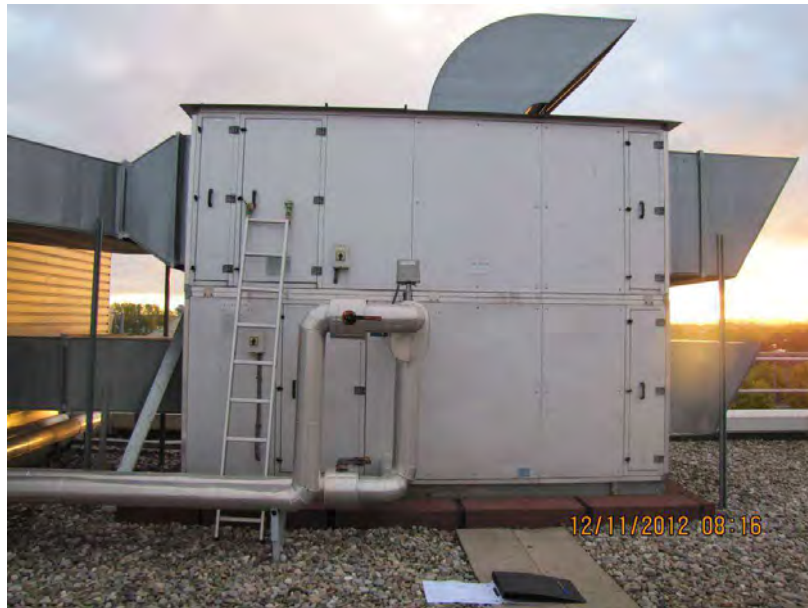
UTA 5, zona cubierta.
