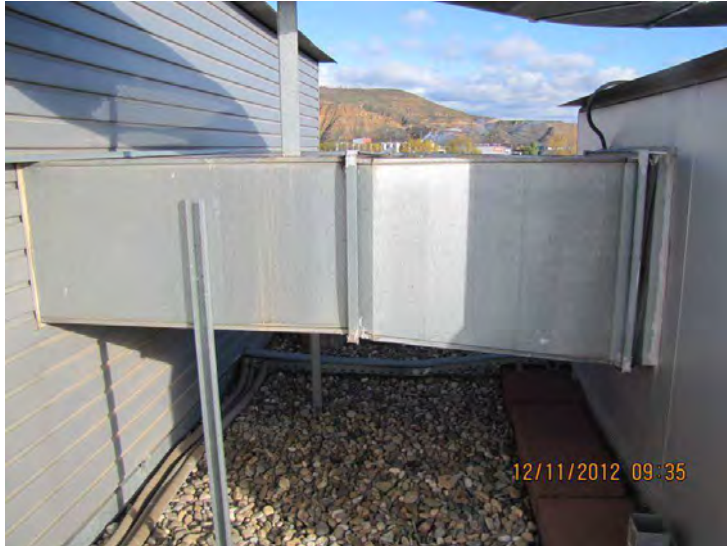
Circuito de impulsión, sin aislar. UTA 2
