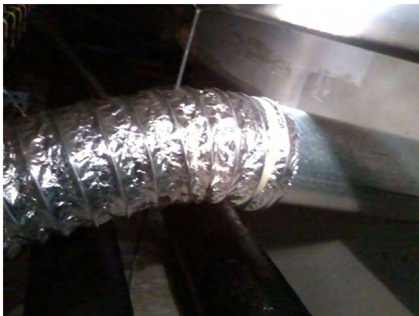
Aislante a la entrada de los fancoils del falso techo.
