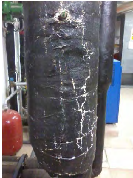
Aislante deteriorado del circuito de impulsión secundario del intercambiador.
