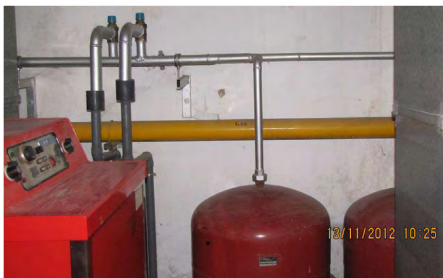
Depósitos de expansión del CCTO primario. Sala de calderas.
