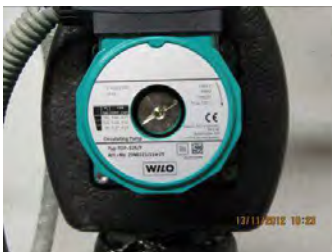
Figura 32.-Bomba de Recirculación A.C.S. edificio CCT
