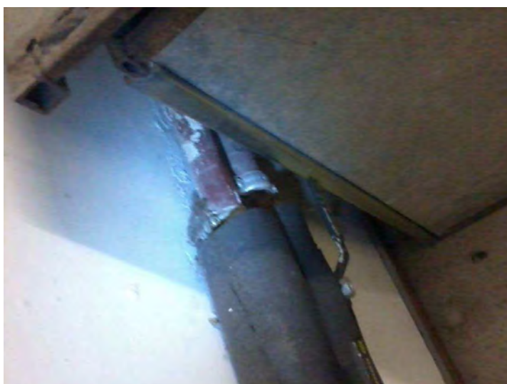
Falta aislante circuito de calefacción, patinillo PB del atrio.
