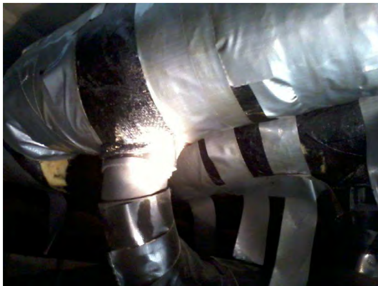
Aislante deteriorado. Lab inorgánica, P2, física y química.
