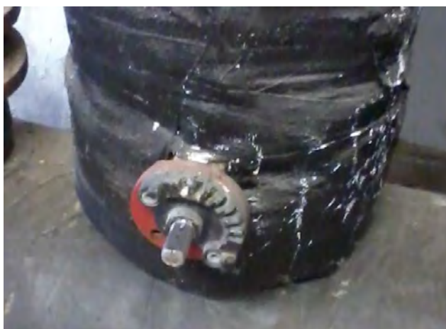
Falta la palanca, situada en sala de bombas.
