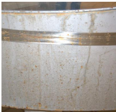
Figura nº 67. Ataque de chapa de acero inoxidable por utilización de agua con alto contenido en cloruros
