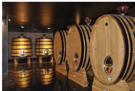
Figura nº 55. Fudres para fermentación maloláctica y almacenamiento de 2.000 L de capacidad unitaria instalados en Bodegas Villarrica (Hervías, La Rioja). Ingeniero Agrónomo: Mercedes Díaz del Río
