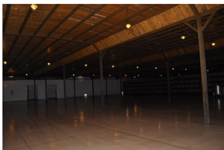
Figura nº 2. Almacén en la antigua Bodega de Paternina en Haro (La Rioja). Actualmente Mariano Lacort. Estructura oculta por falso techo.
