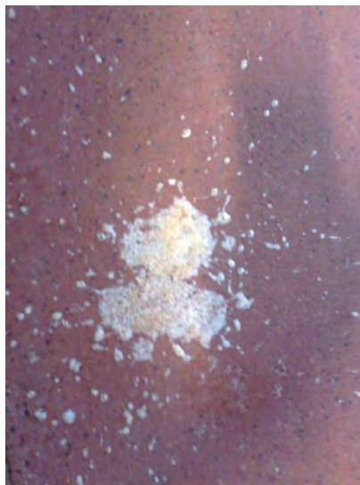
Figura 16: Imagen de suelo higienizado, con su impermeabilidad deteriorada, una vez aplicado el spray revelador de contaminación. Se observa burbujeo blanco intenso por la existencia de contaminación microbiana.
