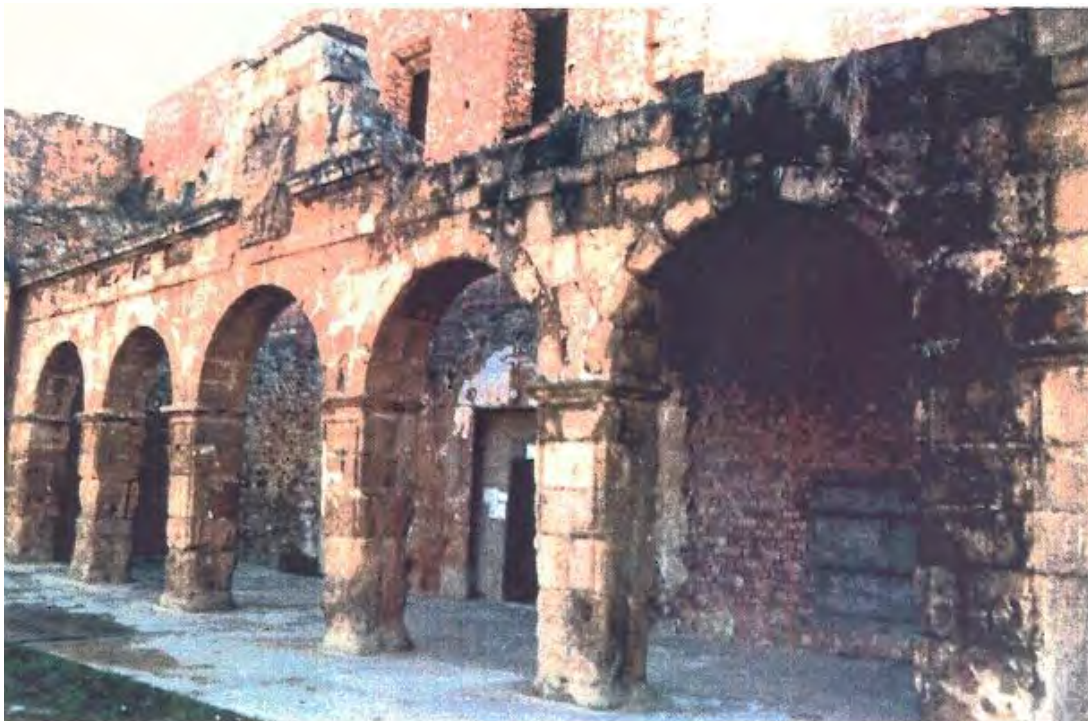
Lám. 187 - Convento de Vico en Arnedo, pórtico de acceso antes de la restauración, (foto 2, Proyecto de Consolidación y Restauración parcial del templo de Nuestra Señora de Vico, Gerardo Cuadra, 1992).
