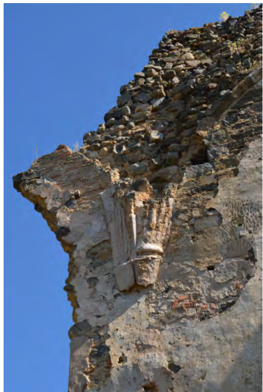
Lám. 112 – Convento de Campolapiente en Cornago, restos de la ménsula y arranque de los nervios de las bóvedas que cubrían los tramos tercero y cuarto de la nave (julio 2013).
