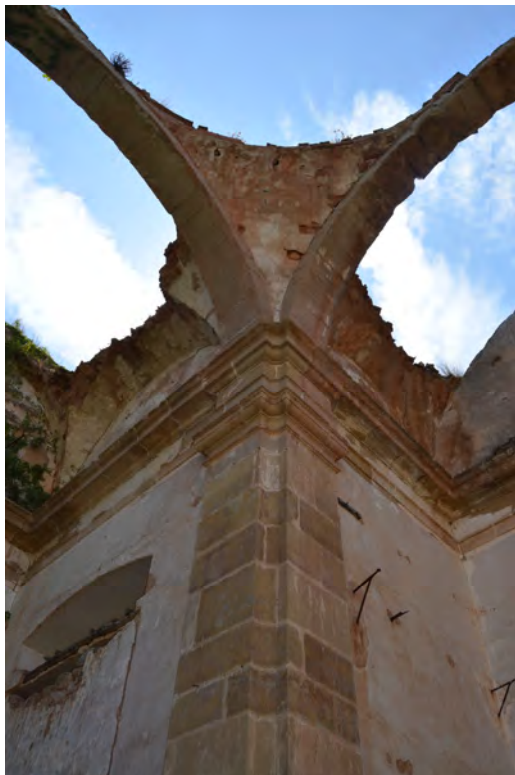
Lám. 129 - Convento de San Antonio de Padua en Nalda, detalle del arranque de los arcos desde el pilar sur de la cabecera (agosto 2012).
