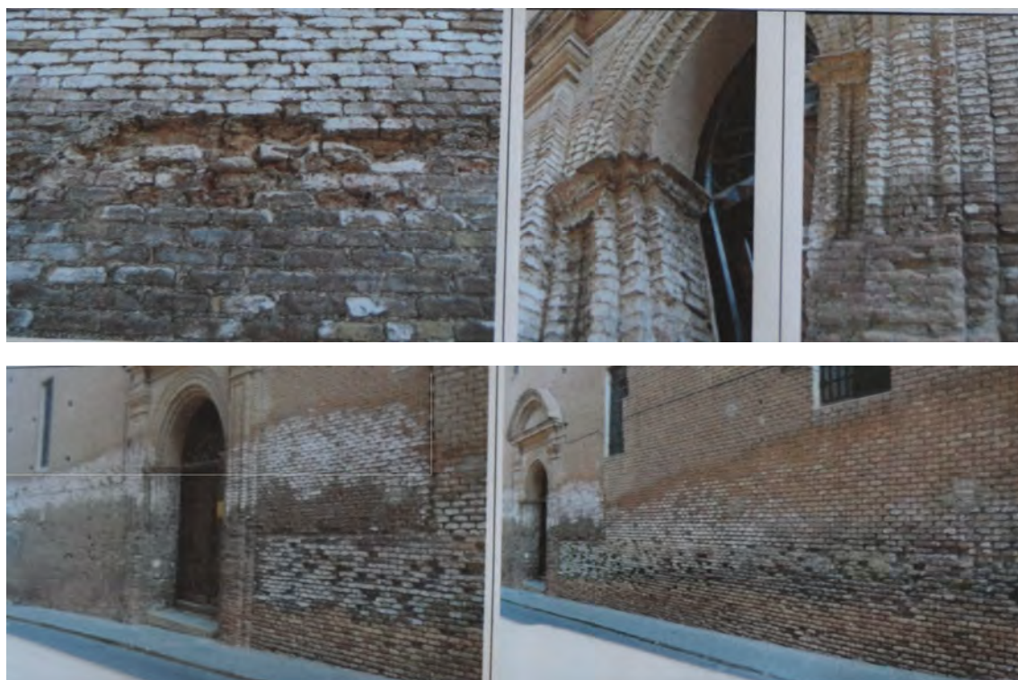
Lám. 329 – Convento de la Purísima Concepción de Alfaro, fachada del convento, estado de la fachada antes de la intervención, fotos del Proyecto de rehabilitación de fachada, Domingo García-Pozuelo y Yolanda Ibáñez en 2003 (AGLR, sig. 41942-1).
