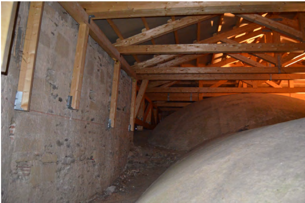
Lám. 217 - Convento de Santo Domingo de la Calzada, parte superior de la cúpula y bóvedas de la iglesia y cerchas de madera sobre las que apoyan la cubrición de la iglesia (agosto 2012).
