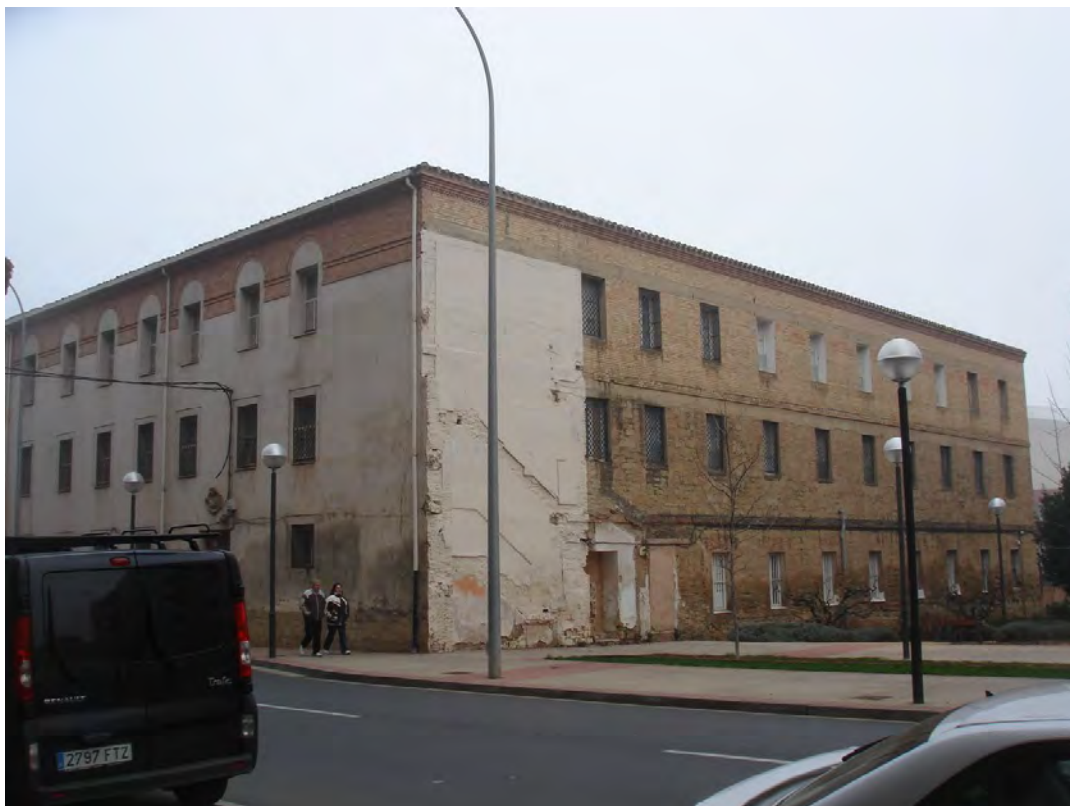
Lám. 175 – Convento de Madre de Dios de Logroño, esquina sureste del convento donde se puede apreciar la medianera del ala que se derribó en el año 2008 (enero 2012).
