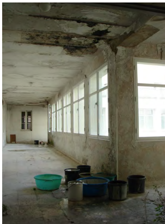
Lám. 265 – Convento de Madre de Dios de Logroño, interior del convento, humedades en claustro en la esquina del ala noreste (enero 2012).
