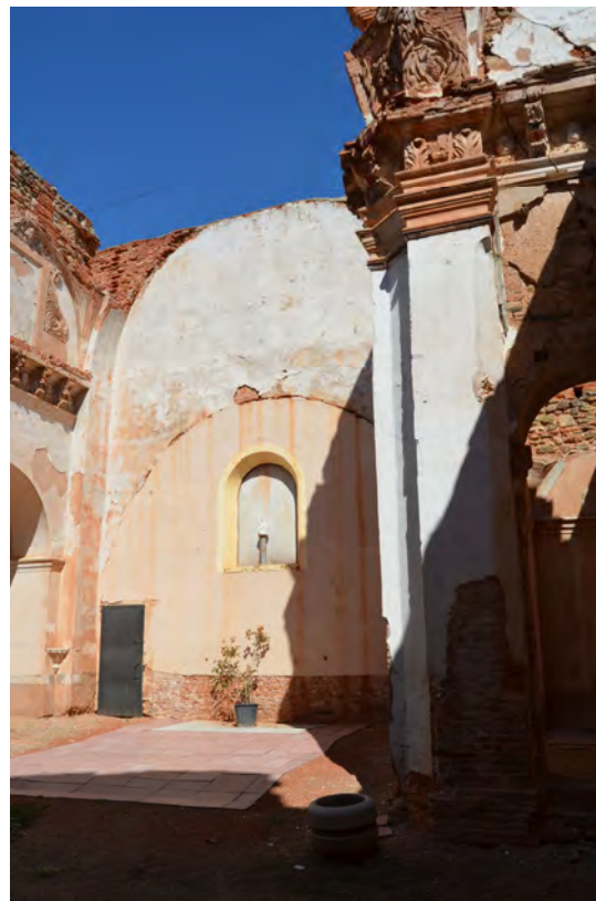
Lám. 158 - Convento de Vico en Arnedo, cabecera de la iglesia en ruinas (7/8/2012).
