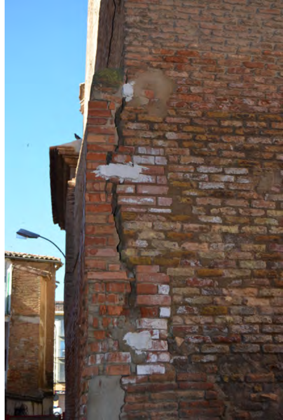
Lám. 267 - Convento de San Francisco en Alfaro, grieta con testigos de yeso en ala este del crucero (julio 2013).
