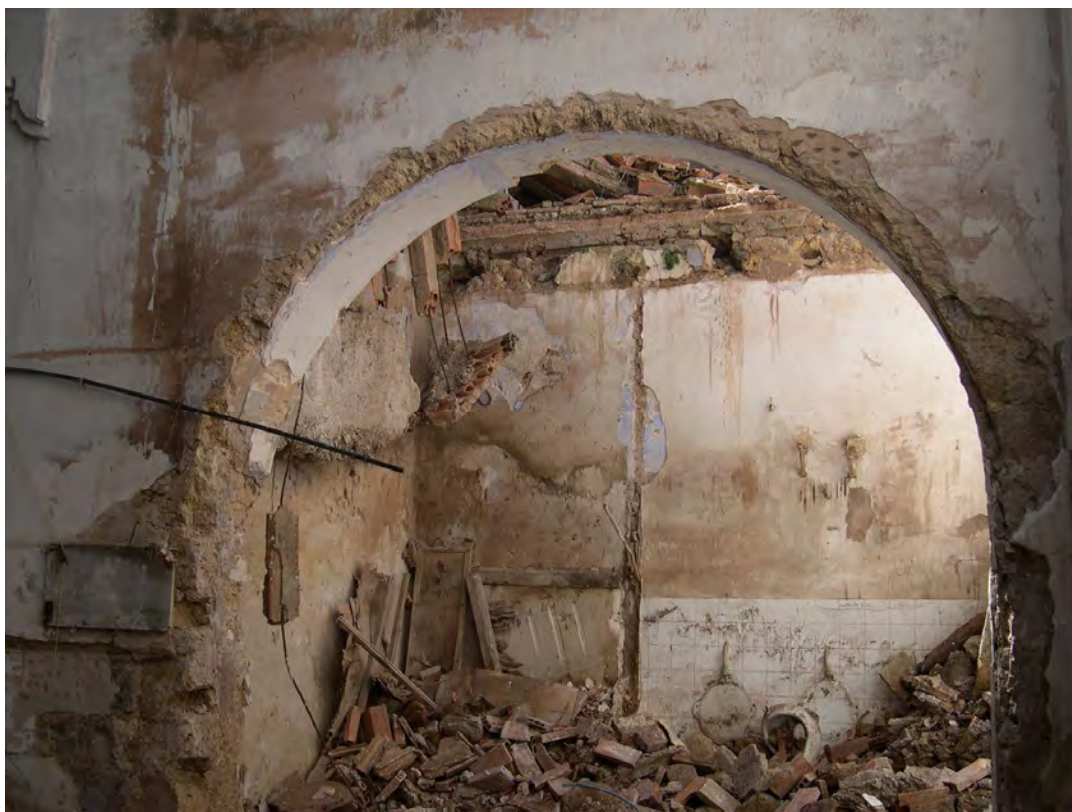
Lám. 341 – Convento de San Francisco en Torrecilla de Cameros, estado de la iglesia en 2008 antes del inicio de las obras, arcada entre la nave principal y el espacio adyacente hacia el norte, cedida por Javier Arizcuren.
