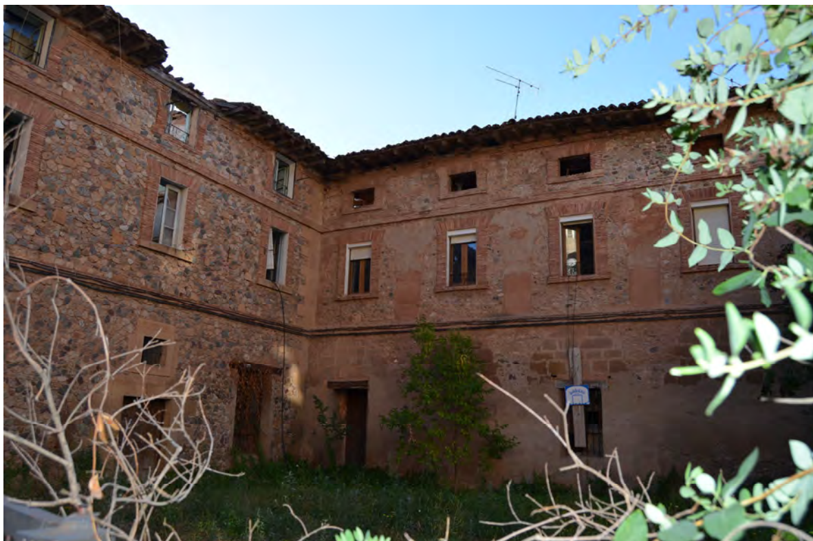
Lám. 161 – Convento de San Francisco de Nájera, alzados oeste y norte a Plaza de Suso (agosto 2013).
