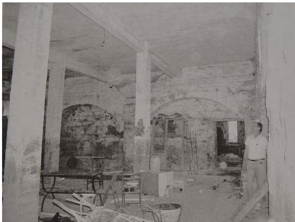
Lám. 238 - Convento de San Francisco de Nájera, interior del ala que se quemó, fotografía obtenida del Informe de ruina, Francisco Mir Brusel, 2004, (AMN, sin nº expediente).
