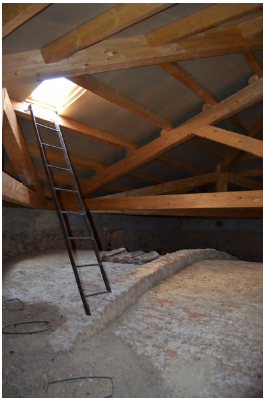
Lám. 218 - Convento de Santo Domingo de la Calzada, salida a cubierta, se accede a la zona donde está situada la espadaña (agosto 2012).
