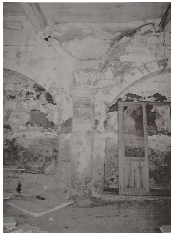
Lám. 237 - Convento de San Francisco de Nájera, interior del ala que se quemó, detalle de columna adosada a muro y arcadas, fotografía obtenida del Informe de ruina, Francisco Mir Brusel, 2004, (AMN, sin nº expediente).
