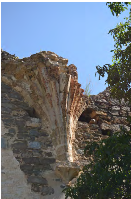
Lám. 111 – Convento de Campolapiente en Cornago, detalle de la ménsula de la que arrancaban los nervios de las cúpulas que cubrían el segundo y tercer tramo de la nave (julio 2013).
