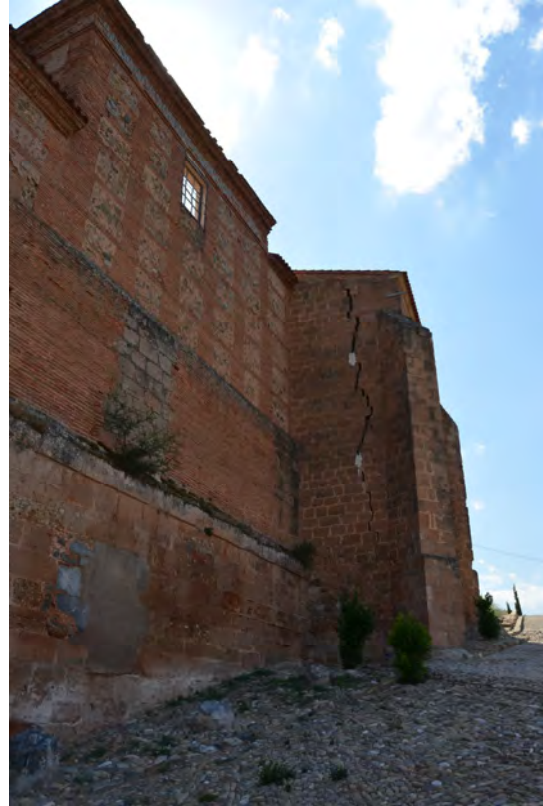
Lám. 199 - Convento de Vico en Arnedo, fachada norte de la iglesia en ruinas (7/8/2012).
