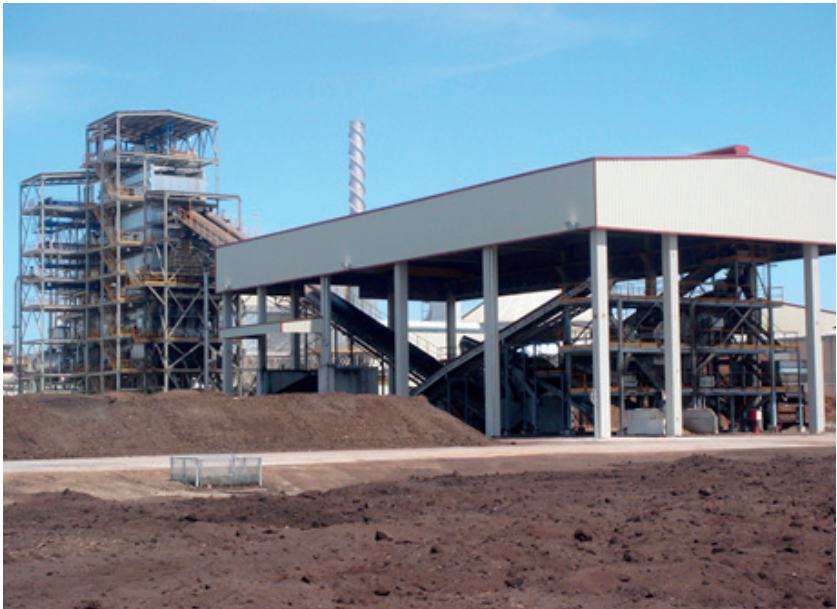
Fotografía 5.9. Planta de generación eléctrica alimentada con biomasa del olivar (Estación de Linares-Baeza)
