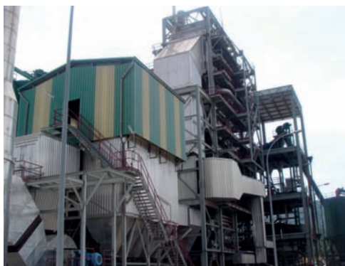
Fotografía 3.3.–Planta de generación de energía eléctrica alimentada con biomasa del olivar (Villanueva del Arzobispo)
