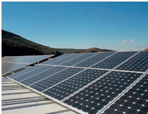
Fotografía 3.7.– Instalación de energía solar fotovoltaica conectada a red (Torres).
