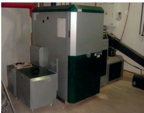
Fotografía 3.11.– Caldera de biomasa para usos térmicos en residencia de ancianos (Alcaudete).
