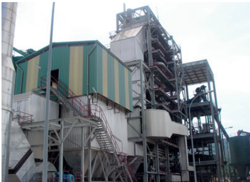
Fotografía 5.7.—Planta de generación de energía eléctrica alimentada con biomasa del olivar (Villanueva del Arzobispo).
