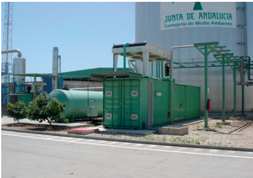
Fotografía 5.6.–Planta de generación de energía eléctrica a partir de biogás de vertedero (Fuerte del Rey).
