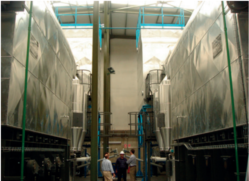
Fotografía 5.10. Sistema de climatización centralizada con hueso de aceituna de Geolit.
