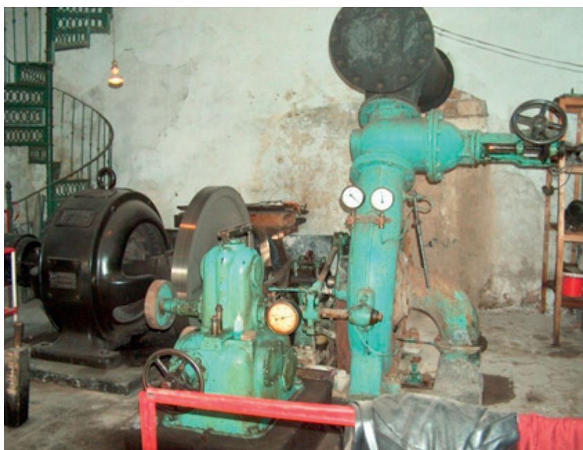
Figura 7.23. Equipamiento electromecánico de la central Mata-Begid.
