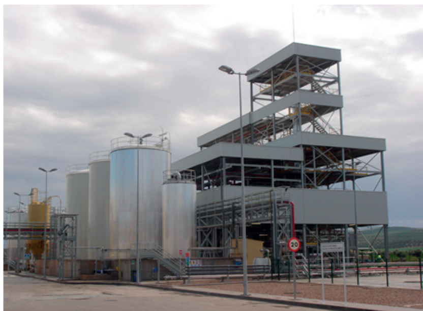
Fotografía 5.8.—Planta de producción de biodiesel (Estación de Linares-Baeza).
