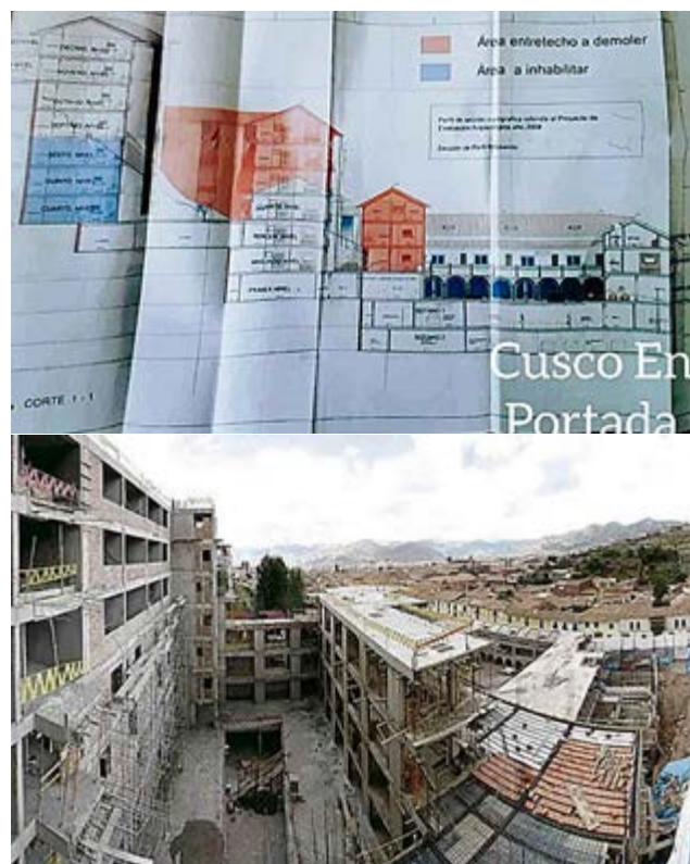
Figura 8. Arriba, fotografía de plano de sección del Hotel Sheraton con propuesta de áreas a demoler e inhabilitar. Abajo, construcción paralizada. Nota: Cusco En Portada (2020), Valdivia (2024a).
