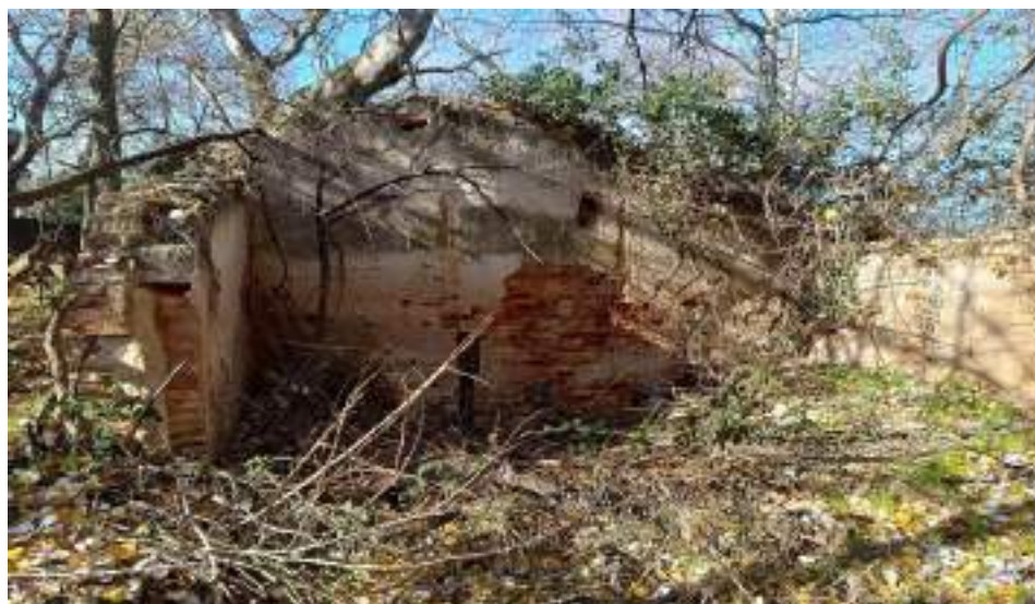
Figura 73: Casa de la Almenara donde se observan tres de las cuatro paredes y el techo derrumbado a dos aguas. Fuente: Foto autor.
