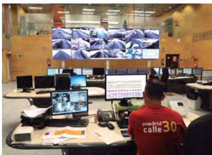
Fig. 12. Sala de control de Madrid Calle 30. Fuente: Ayuntamiento de Madrid.
