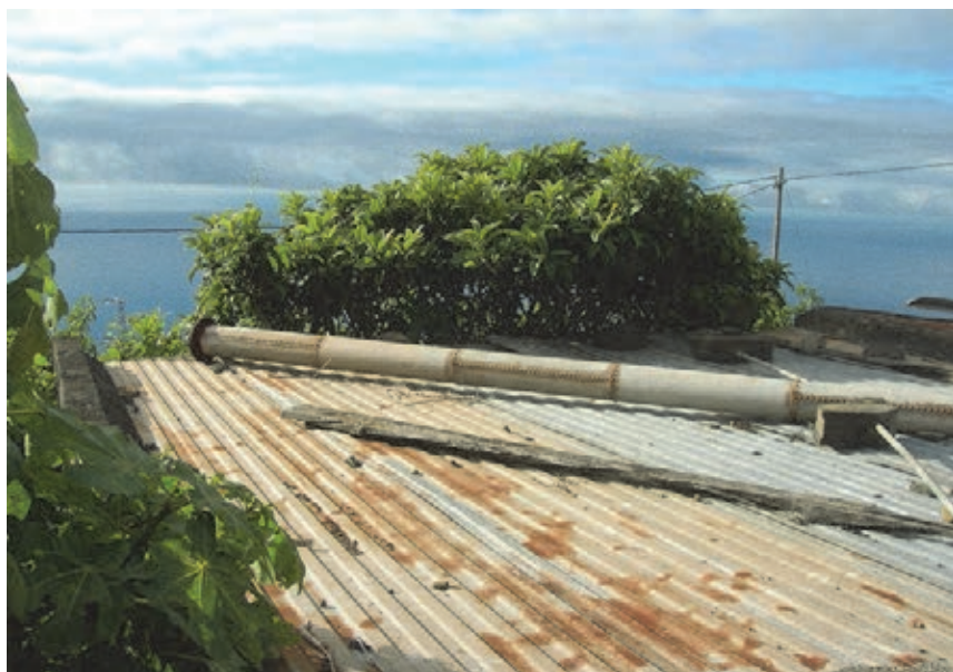
Ruinas de la casa del molino de Gallegos y restos de la tubería, 2016 [ALT]
