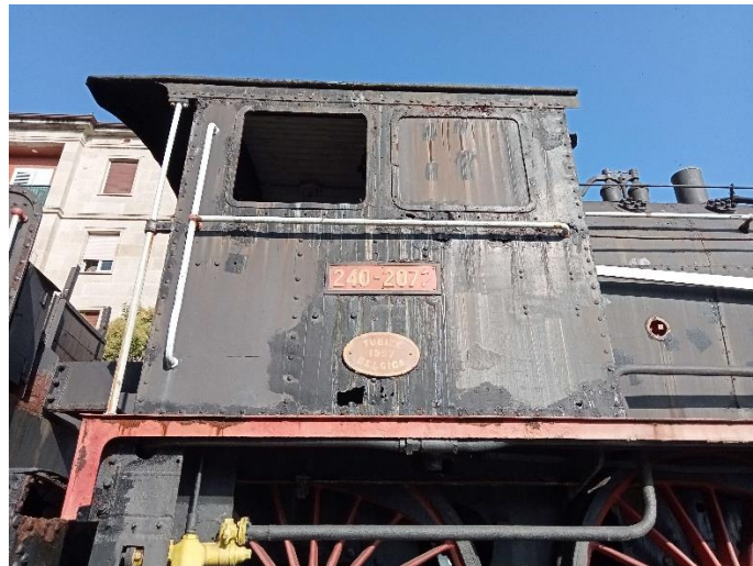
Figura 7: Detalle de corrosión en los mamparos laterales y en los remaches de la cabina del maquinista. Además de las notables delaminaciones de las chapas, hay varios agujeros (Fotografía del autor).
