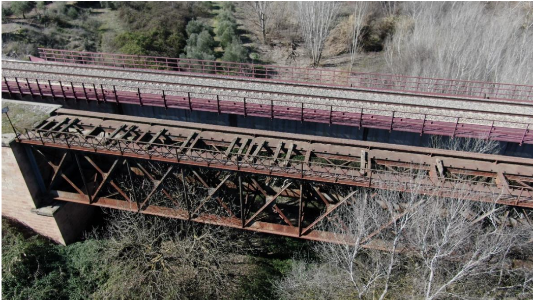
07. Detalle de la viga en montantes separados y celosía sencilla, entre el pilar central y el estribo.
