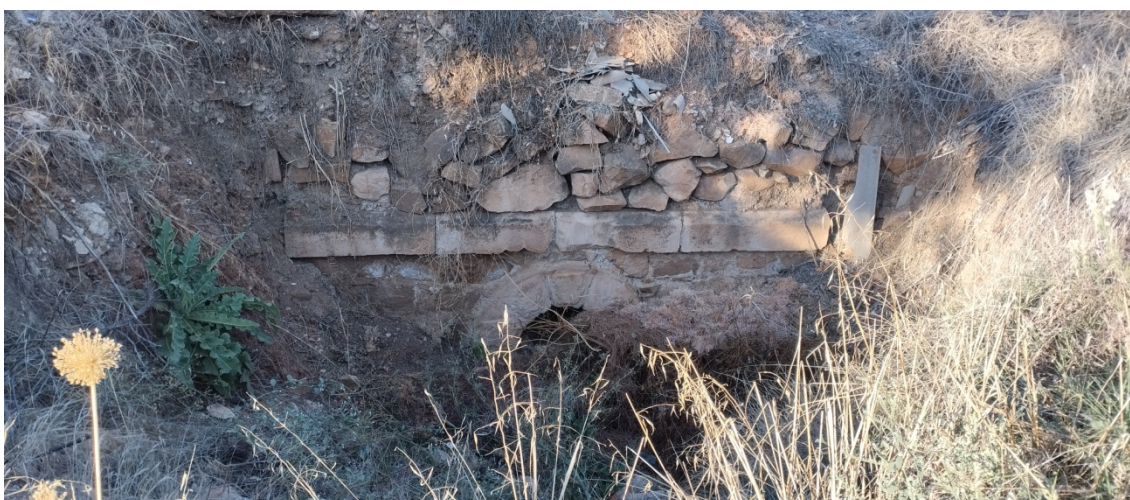
Alcantarilla en el camino de la Mina La Gitana (24), en un tramo abandonado cerca de la Urbanización San Roque de Linares
