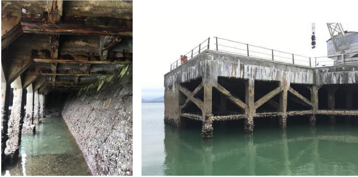
Figura 20: Corrosión avanzada y pérdida de materiales en vigas y pilares del interior de los pórticos del muelle (izquierda); vista de la estructura exterior desde el mar, en las inmediaciones de la “Grúa de piedra”, a la derecha (Fotografías de [8] y [14]).
