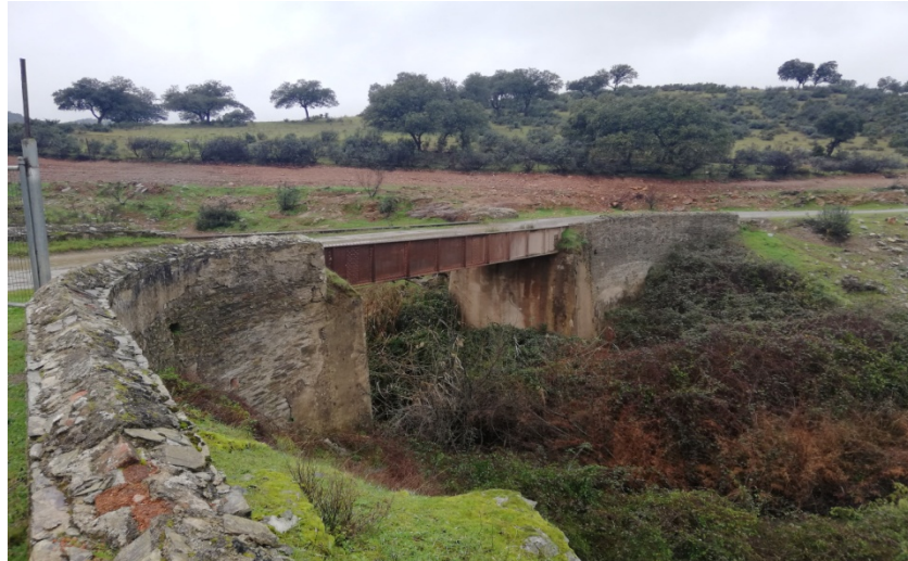
Puente sobre el arroyo del Renegadero, desde el camino de la Mina La Española (10)
