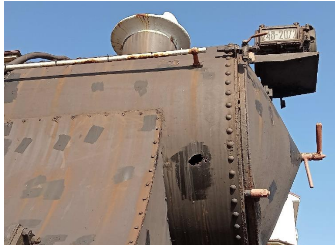
Figura 8: Efectos de la corrosión sobre la caja de humos (agujereada), la chimenea y el farol superior; este último todavía conserva el cristal con la identificación de la máquina (240-2072). Fotografía del autor.
