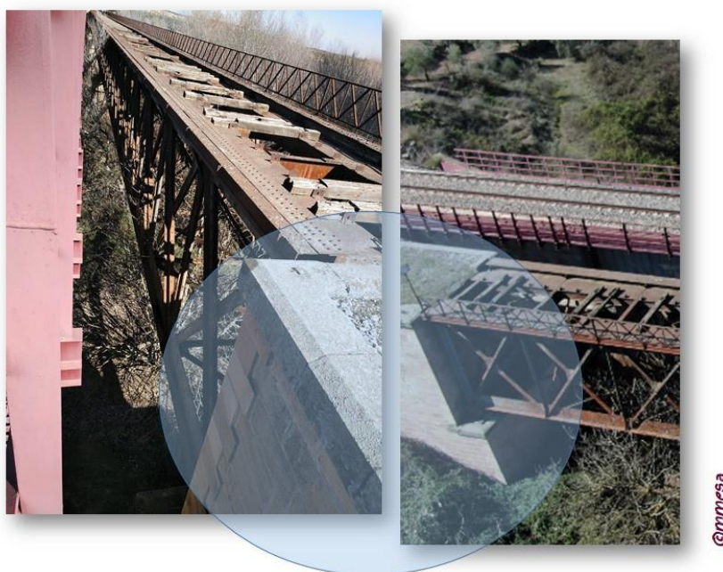
Detalle de los estribos macizos de hormigón coronado por mampostería con chaffanes en sus extremos revestidos de sillarejo.
