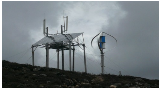
Figura 7. Turbina híbrida eólica vertical DS300, con capacidad para generar 3kW de potencia, instalada cerca de una torre de telecomunicaciones a la cual le brinda energía con ayuda también de paneles solares [21]
