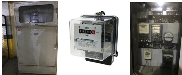
Figura 2. Contadores del edificio
