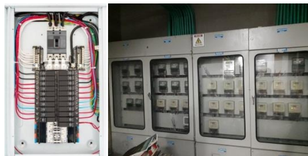
Figura 17. Tablero de circuitos
