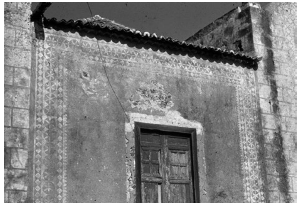
Fachada trasera de la iglesia de Bonanza, con la casa de los patronos y el camarín de la Virgen. AHMLA
