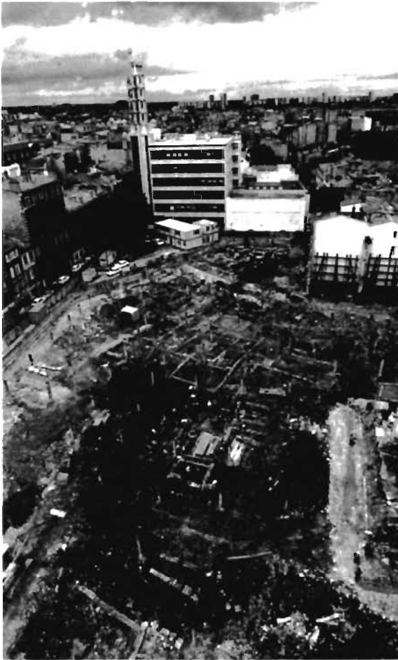
Fig. 8. Vue aérienne d'un grand chantier de fouilles au cœur de Bordeaux: Saint-Christoly, 1982 (cliché M. Gauthier).
