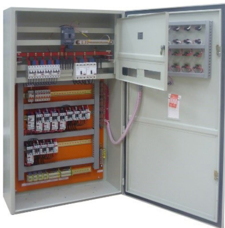
Figura 26. Tablero de distribución principal Fuente: [15]
