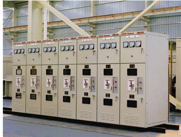
Figura 27. Tablero de distribución secundario 4 Fuente: [16]
