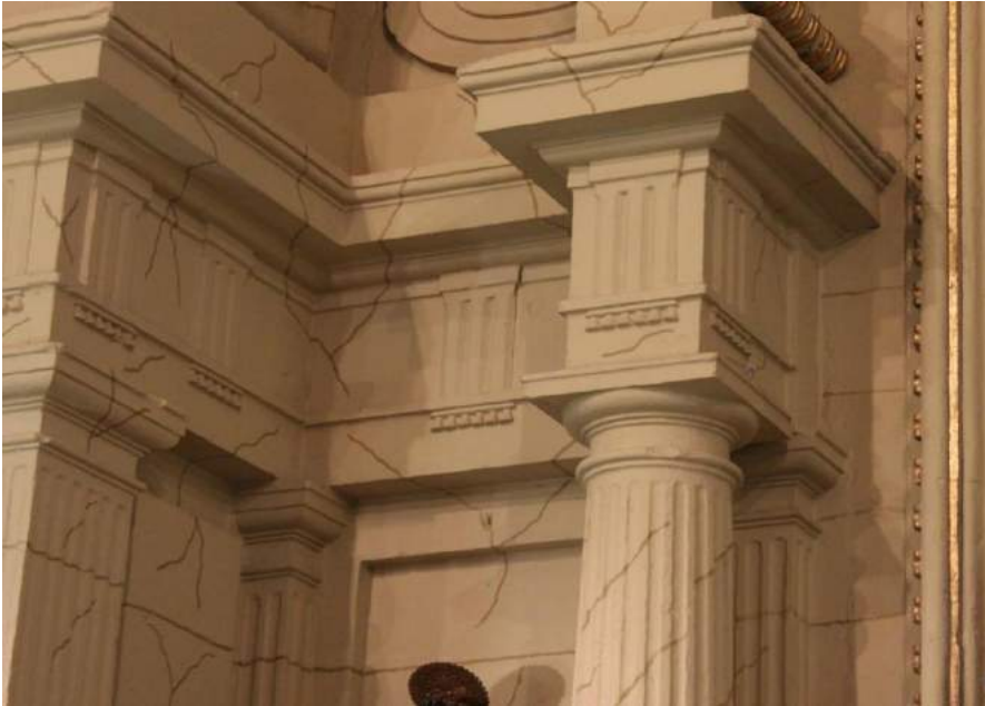
[50] Detalle del cornisamento que separa el primer del segundo cuerpo. Capilla mayor de la iglesia del ex convento de Santa Isabel de los Ángeles, Córdoba. Juan de Ochoa. 1583.
