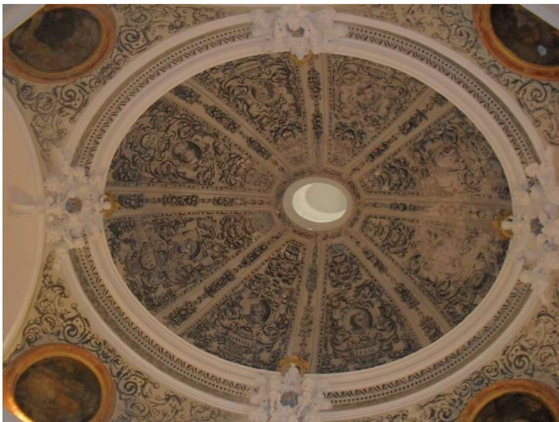
Fig. 27. Cúpula , Francisco Hurtado Izquierdo (atribuido). Ermita de Nuestra Señora de la Alegría, Córdoba. Foto: MARM.
