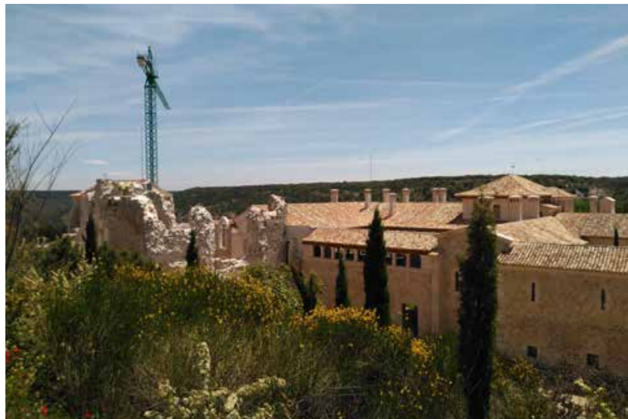
1. Obras de reconstrucción del Monasterio de San Pelayo de Cerrato, en Cevico Navero, Palencia, dirigidas por Rafael Manzano Martos para la Fundación Grupo Siro 2. Empedrado recientemente realizado en Atalbéitar, Granada, por el maestro Jacobo García Martínez
