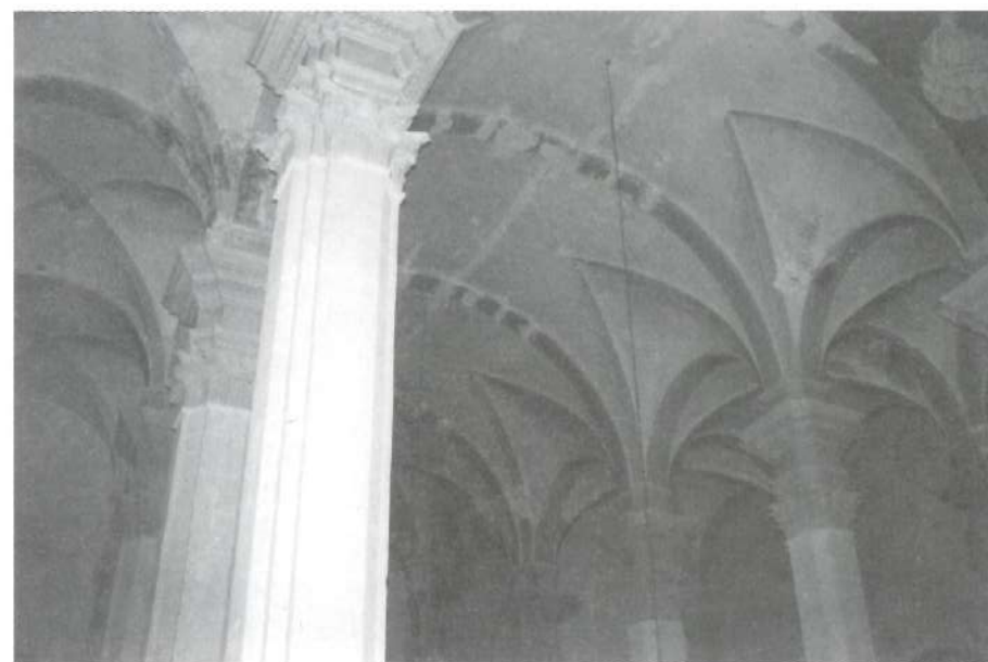
Fig. 39. Vista de les voltes de l'església de Maldà. A la nau central la volta és de canó amb llunetes i a les naus laterals les voltes són d'aresta. (Foto: I. Puig.)
