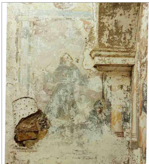
San Francisco de Asís, antes de su restauración
