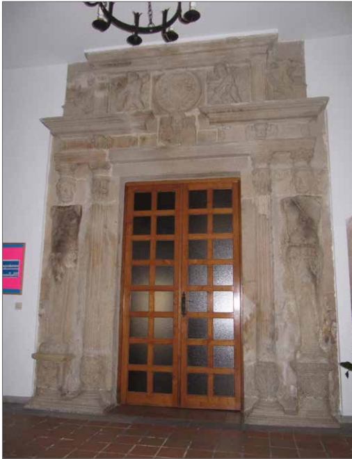
Portada de acceso a uno de los salones, renacentista, con architrabe repleto de angelotes y otras figuras.
