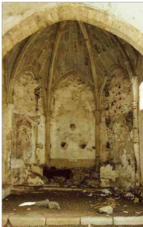
Capilla Mayor antes de su restauración
