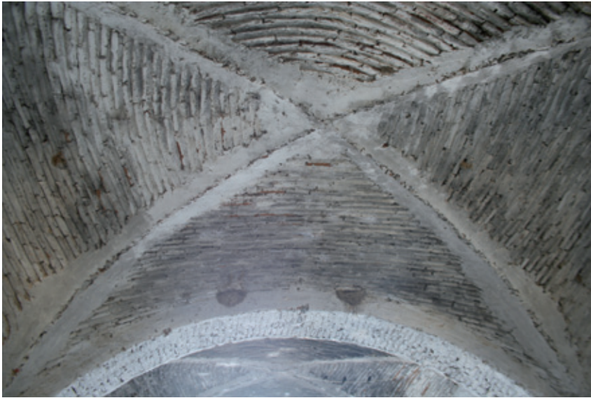
▲ Arroyo de La Luz (Cáceres). La bóveda de aristas forma parte de los elementos sustentados más comunes de la arquitectura de nuestros pueblos.
