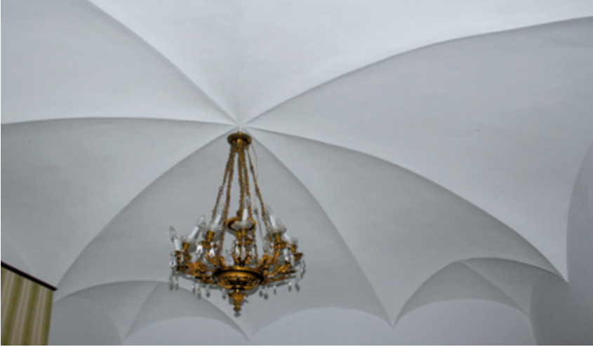
▲ Fregenal de La Sierra (Badajoz). Bóveda de paraguas. Sorprende la variedad de entresuelos de las viviendas de mediano propietario en la Baja Extremadura. Además de la habitual bóveda de aristas, no faltan otras que requieren mayor complejidad constructiva.
