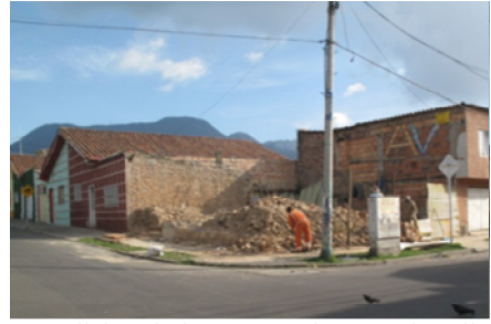
Demolición de la casa esquinera en la calle principal de la Urbanización. Es una foto de registro de la demolición. Febrero de 2011. Fuente: Archivo del autor.
