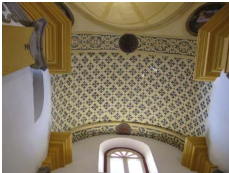
Popayán, detalle de una boveda del templo de San José después la obra de restauración (foto: archivo del autor)
