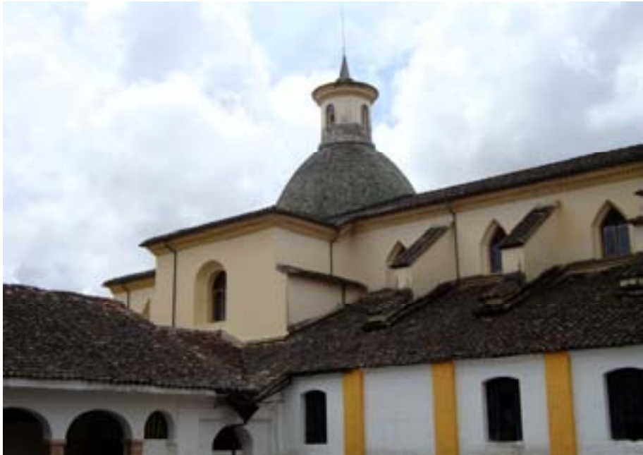
Popayán, la cúpula del templo de San José después la obra de restauración (foto: Olimpia Niglio, 2011)
