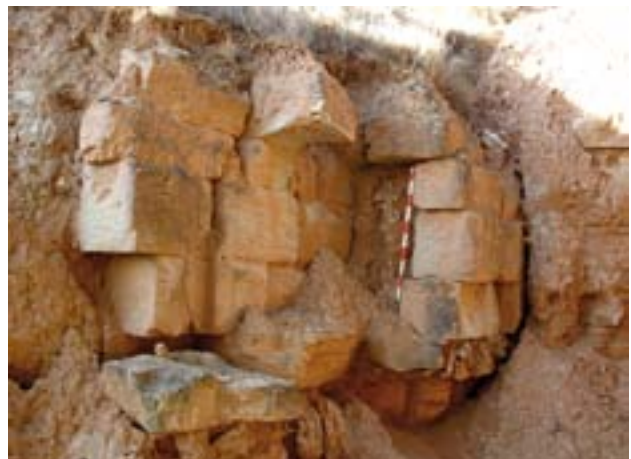
Estado actual del desagüe de fondo de la presa. Foto J.L. Cinca.
