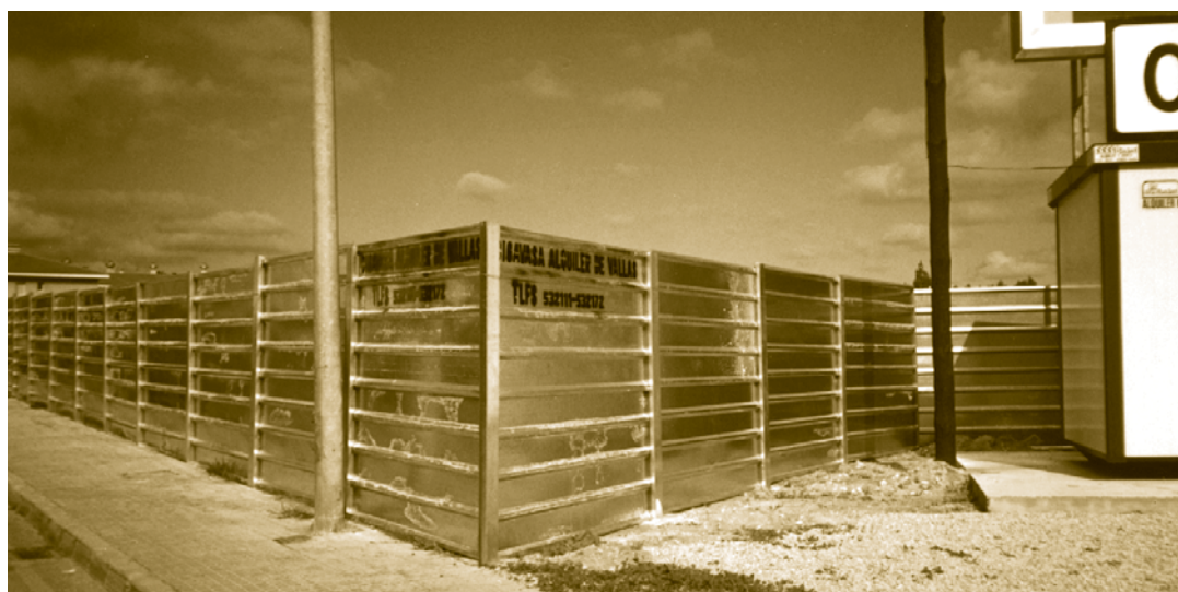
Cerramiento en chapa ciega.
