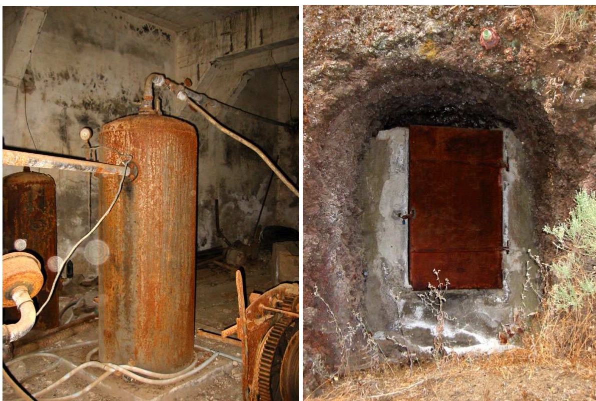
FIG. 44 De izquierda a derecha depósito para acumulación de aire comprimido; Construcción contigua para guardar los aperos. La Lechucilla Vega de San Mateo. 2003. FUENTE: Colección privada.
