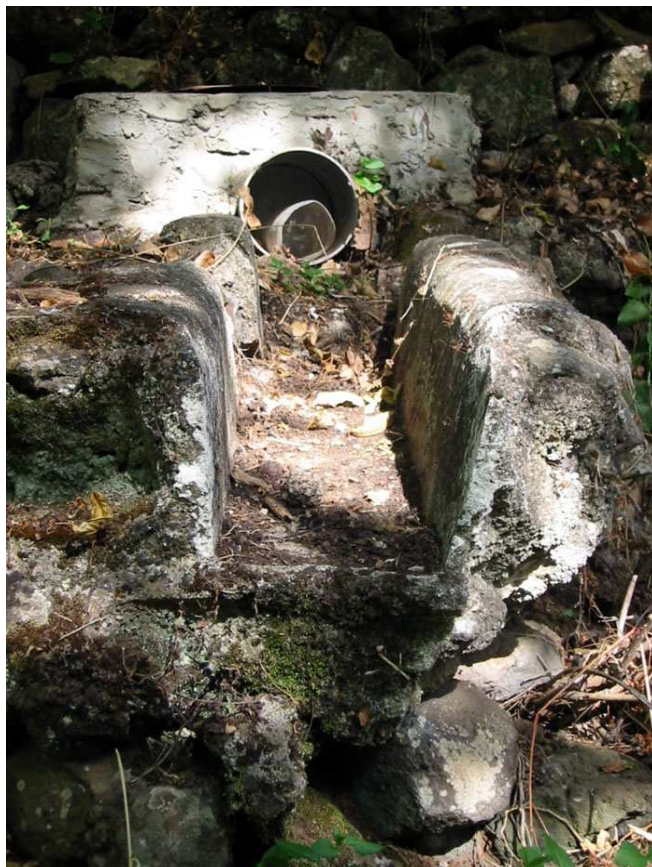
FIG. 33 Tramo de acequia seccionado (La Lechucilla). Vega de San Mateo. 2003. FUENTE: Colección privada.
