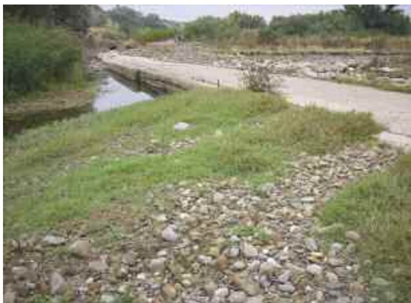
Presa de Sorbán en el Río Cidacos (margen izquierda aguas abajo). Fotografía: Arturo Pérez Fernández.
