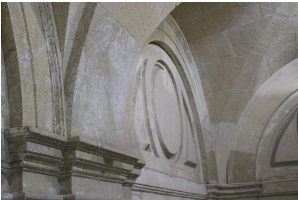
Figura 41. Arranque de una bóveda, Casa Lonja de Sevilla. Se advierten restos de estuco, aunque no es posible datarlos con exactitud. Foto autor.
