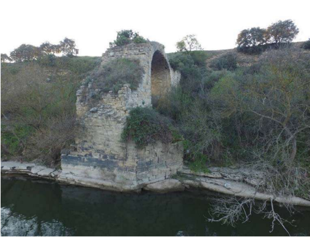
Fig. 28: Estado previo al derrumbe. Erosi n por estratos del sustrato rocoso
