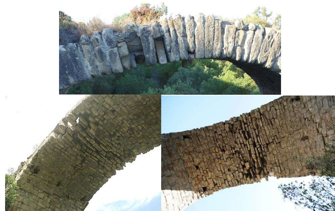
Fig. 33: Diversas vistas de la bóveda en los meses previos al colapso
