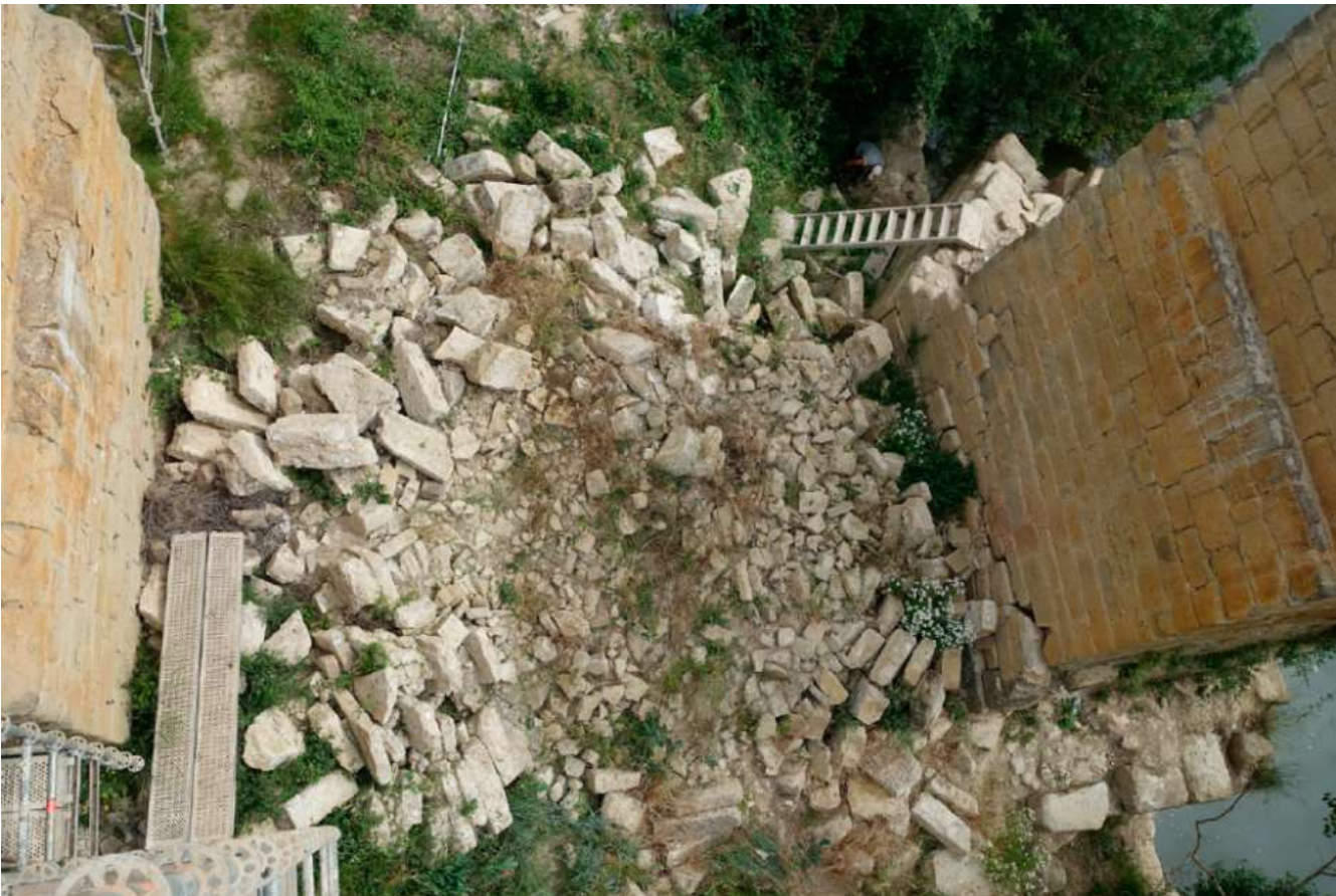
Fig. 48: Vista cenital del montón de piedras caídas en el segundo nivel de recogida.
