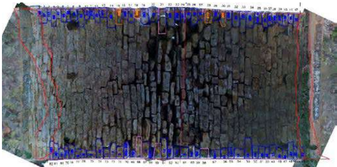
Fig. 55: Intradós del arco antes de su derrumbe con identificación de piezas de boquilla y de hiladas.
