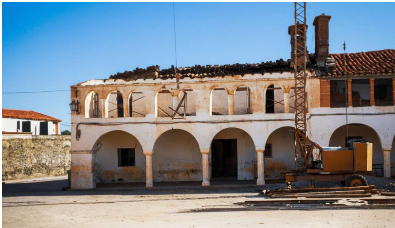
Arreglo de los portales y soportales de las posadas.
