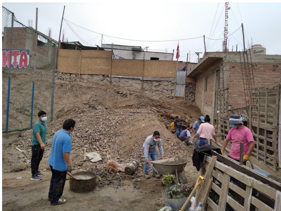
FIGURA 7. Realización de faena comunal para la construcción de escaleras en el asentamiento humano Villacanta, Independencia
