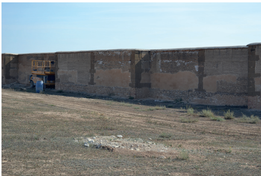
Muro de cierre perimetral, en el que pueden apreciarse estratificados los diferentes tapias que lo componen.
