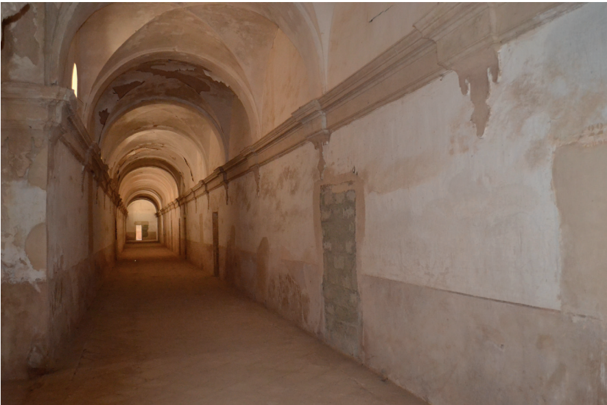
Corredor pendiente de rehabilitación.
