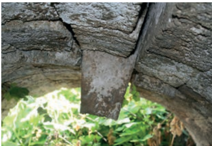
Arco de c/ Conde de Superunda. Bóveda vencida con deslizamiento de dovelas.
