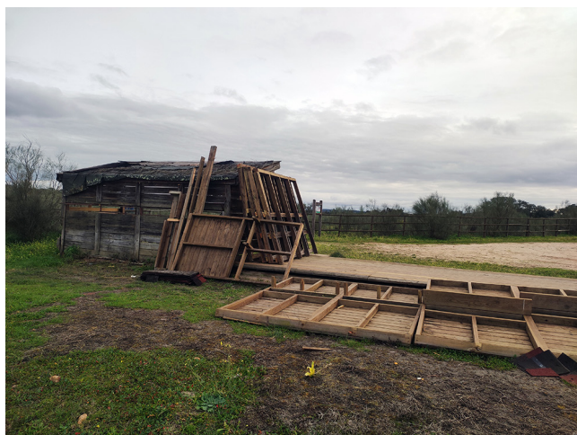
a) deterioro del observatorio de aves
