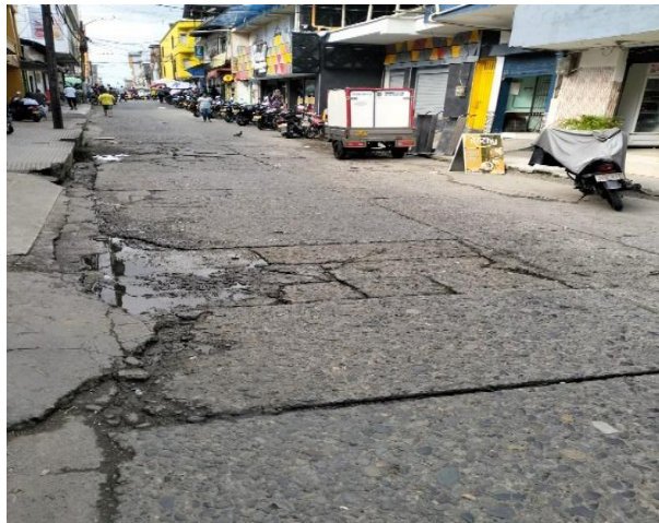
Fractura de Pavimento de Carrera 6a con entre calles 25 y 26 de la ciudad de Quibdó
