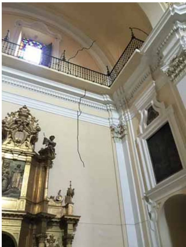
10. TRAZADO REMARCADO DE LA GRIETA SOBRE EL MURO DE CIERRE DEL TRANSEPTO DE LA EPÍSTOLA. FOTOGRAFÍA DEL AUTOR.
