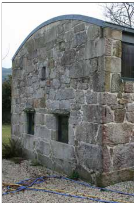
Testeiro norte, no que inda se aprecia a pedra adicionada para acadar altura suficiente para o primeiro andar.
