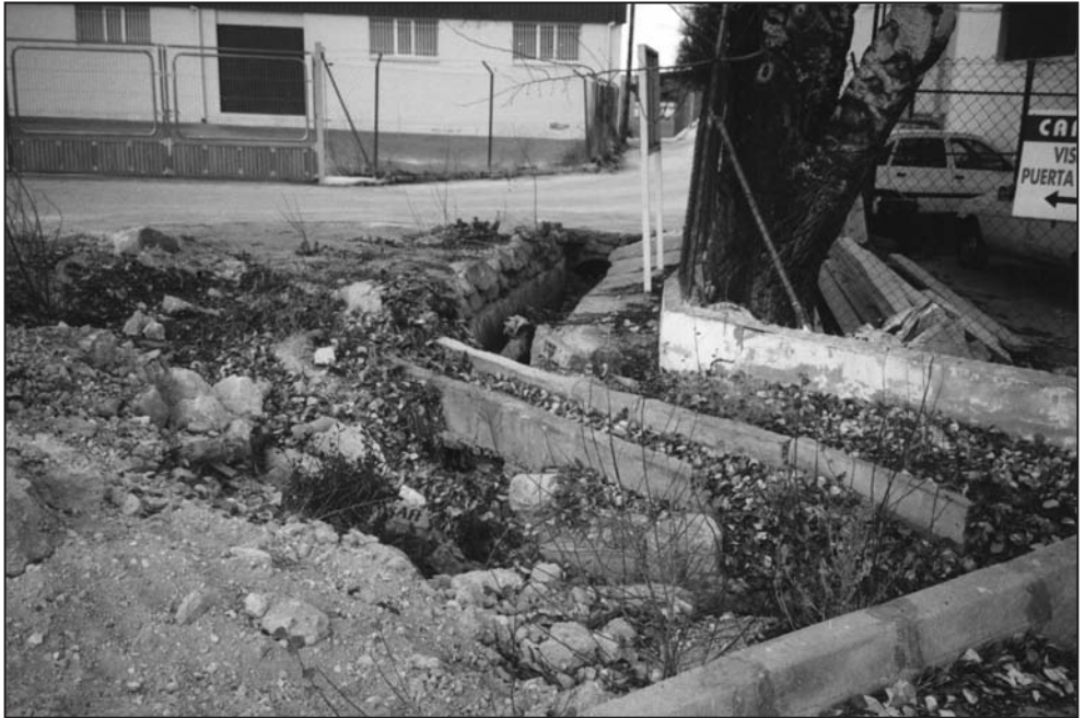
Figura 4. Red de acequias abandonadas por el avance de las construcciones.
