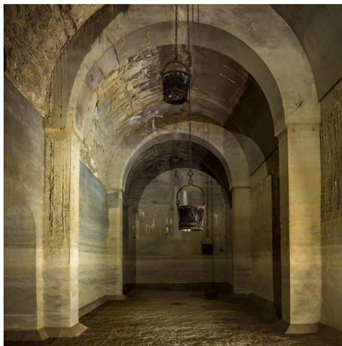
Fig. 7. Interior del aljibe de Tendilla en el recinto de la Alhambra. Se pueden apreciar las lumbreras abiertas en las bóvedas y actualmente tapadas por las que se introducían los calderos de madera sujetos por cadenas metálicas para extraer el agua desde los brocales exteriores. Granada, Patronato de la Alhambra y Generalife.
