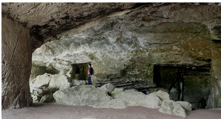
Fig.6: Cova de la Mare de Deu. Bloques de diferentes tamaños y grosor ocupan el suelo de la pedrera tras haberse desprendidos del techo a causa de los colapsos. Foto: J. Bermejo
