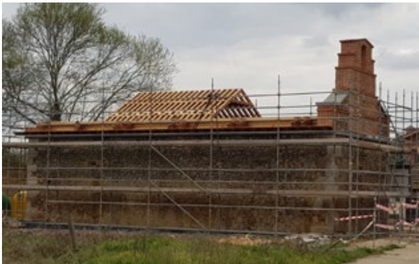
Installation of the new roof framework | Proceso de colocación de la nueva armadura de cubierta | Processo de instalação da nova armação da cobertura
