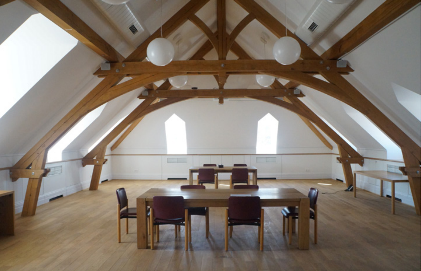
Oaken roof structure | Estructura de roble del tejado | Estrutura do telhado em madeira de carvalho
