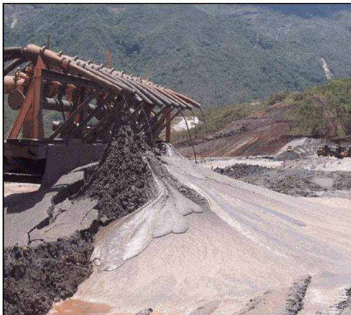
Figura 8 - Bateria de hidrociclones localizados na crista de uma barragem.
