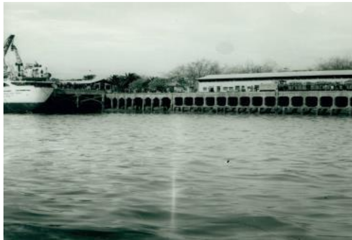
Figura 16: Pórticos de hormigón del Muelle de Maura vistos desde el mar [13]. Circa 1950.
