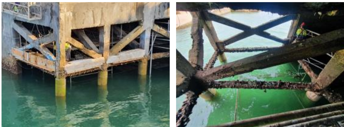
Figura 19: Efectos de la corrosión en el exterior e interior de los pórticos de la estructura del muelle (Fotografías de [8] y del autor).
