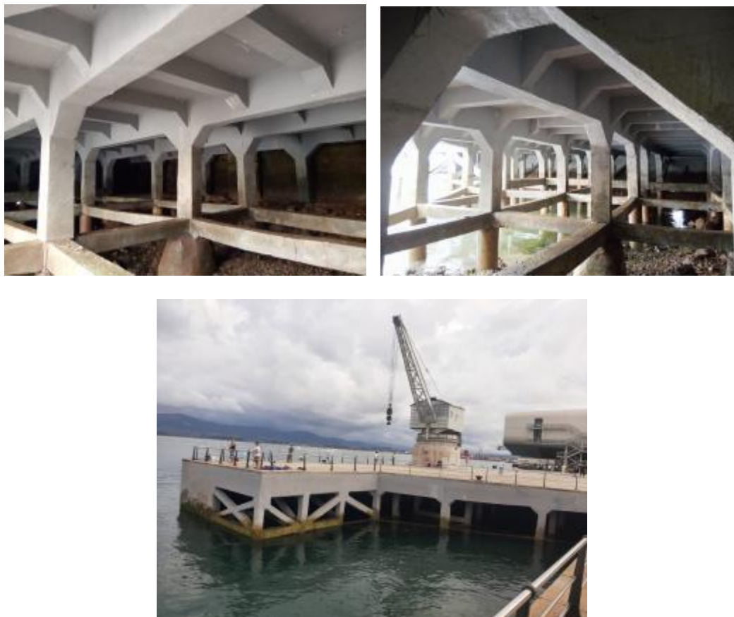
Figura 29: Diversas vistas del Muelle de Maura una vez restaurado, tras la finalización de las obras (Fotografías de [8] y del autor).
