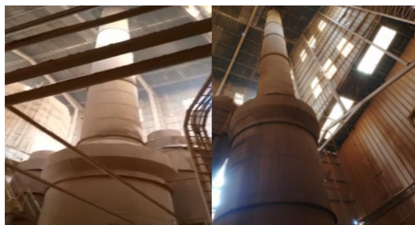
Fig.13 Ducto de la chimenea real donde se obtendrá el calor residual del mismo [Fotografía], Investigadores, 2022.
