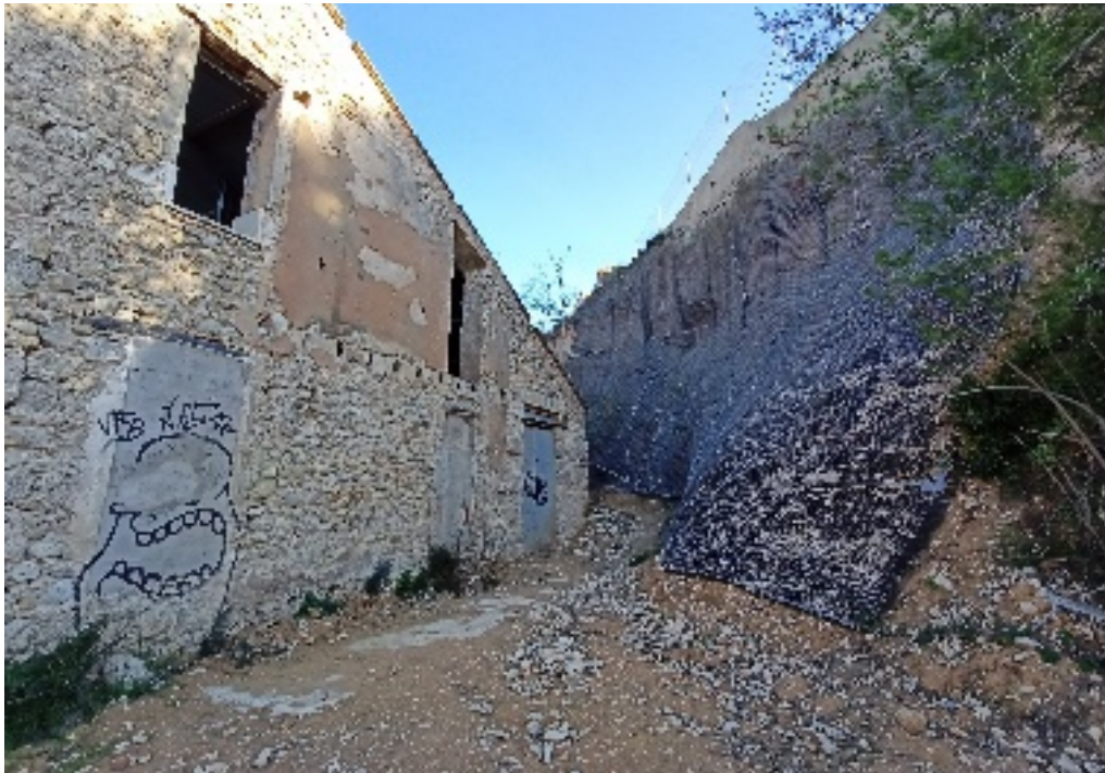
Fotografia 12. Malla de protecció per a evitar el desprendiment de vessant darrere de la fàbrica d'Els Solers.
