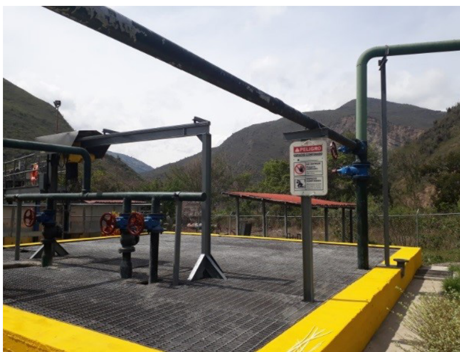
Fig. 4. Vista superior del tanque de igualación u homogeneización. Fuente: autores.
