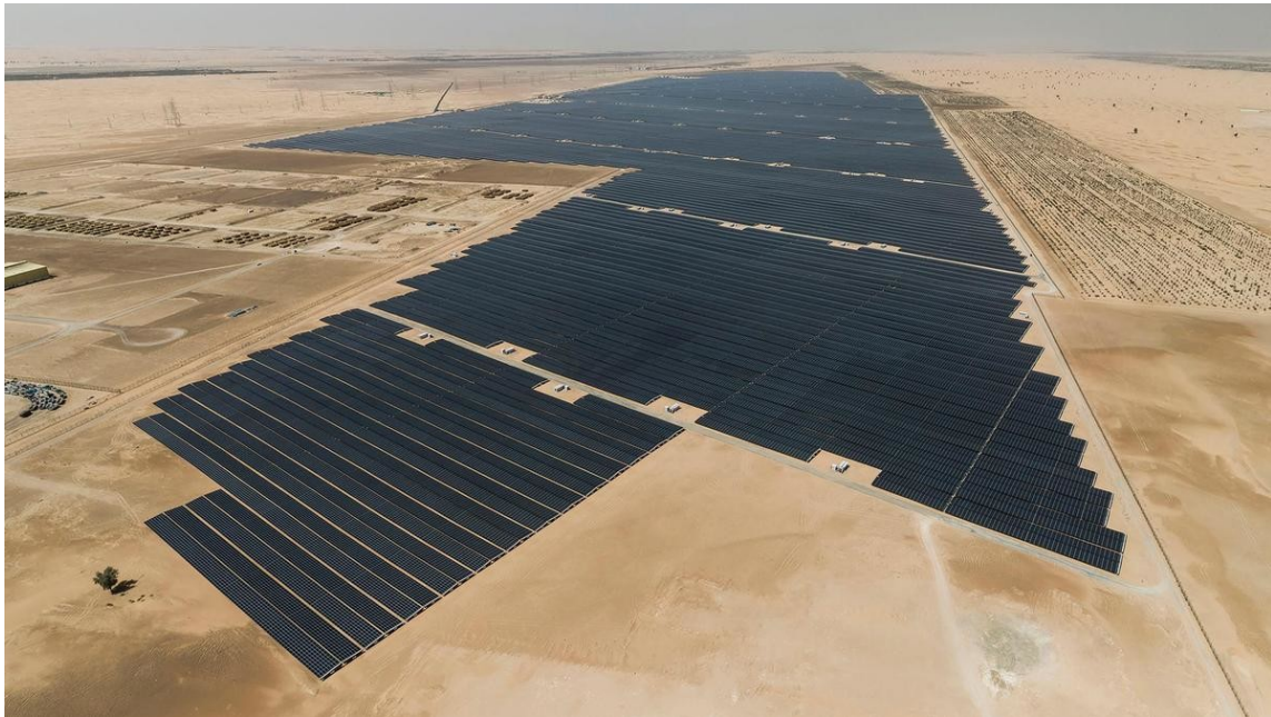
Fig. 6. Planta de energía solar.
