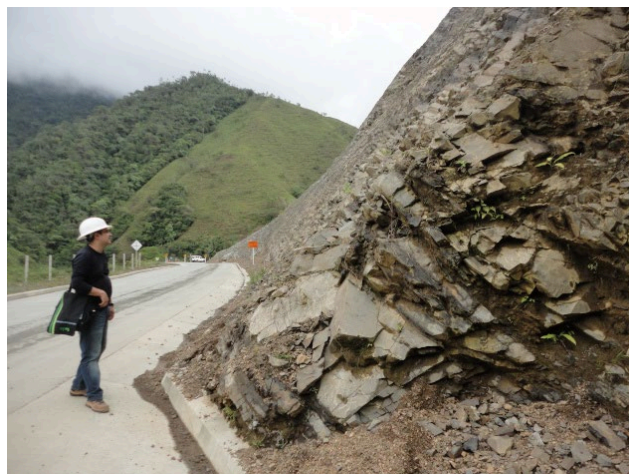
Figura 5. Macizo rocoso del talud izquierdo de la vía Quibdó a La Mansa en el sitio de estudio (foto tomada en el sentido inverso al aumento de las abscisas, i.e. de La Mansa a Quibdó).
