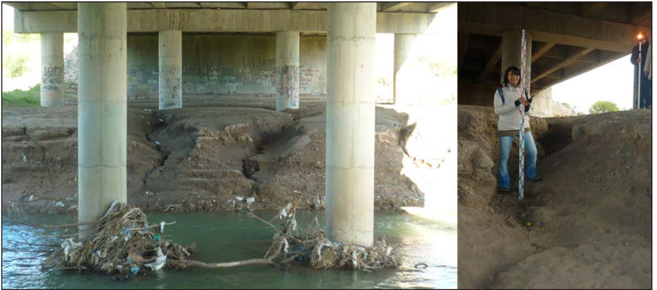
Figura 19. Cárcavas sobre margen derecha del río Arenales que afectan pilas del puente.
