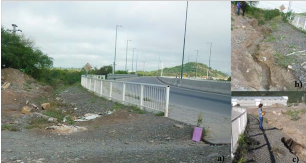
Figura 4, a, b y c. Progresión del cárcavamiento, en la margen izquierda del puente del río Arenales.
