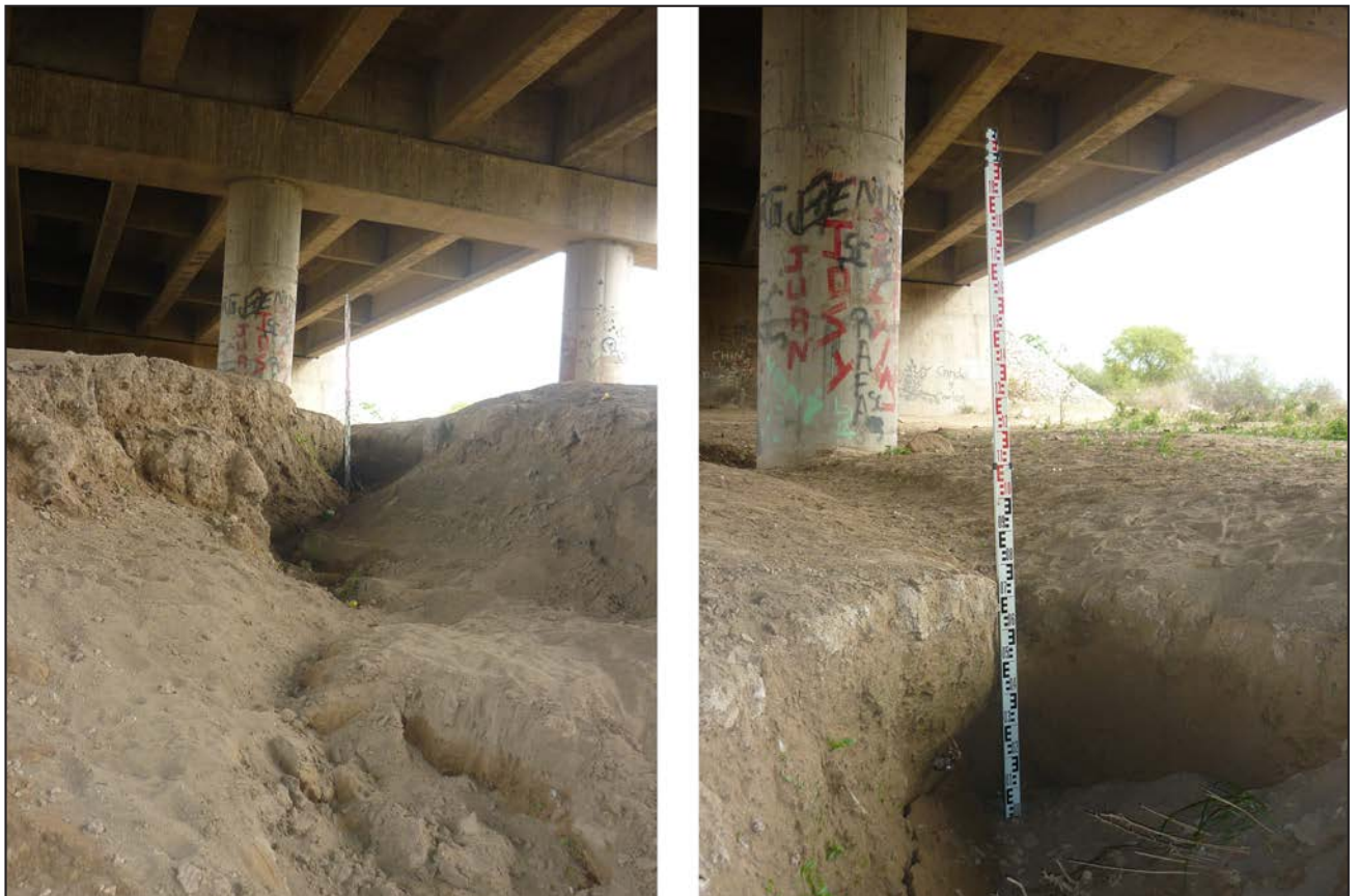
Figura 7. Surcos de erosión en la margen derecha del río Arenales.
