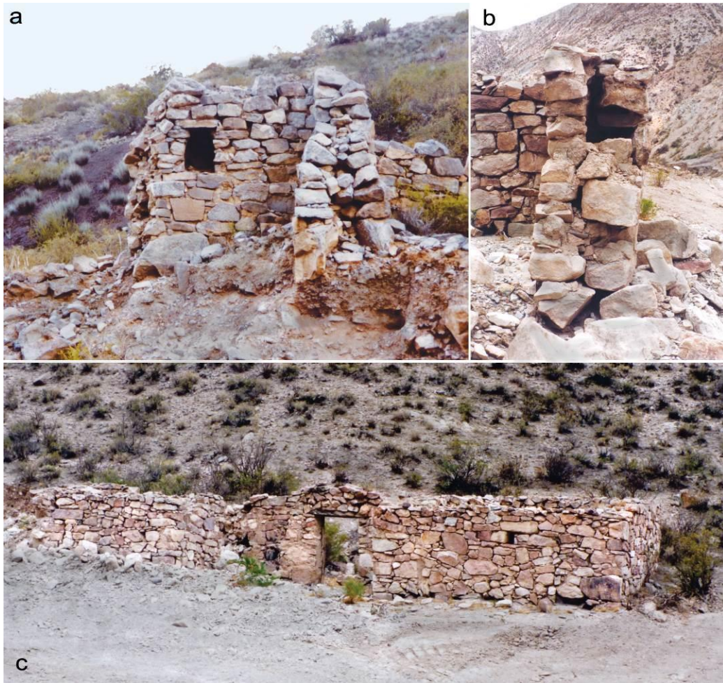
Figura 3. Construcciones modernas con “rasgos incaicos”. a) Hornacina y muro de doble hilada de Los Blanquitos; b y c) Muro de doble hilada y vista general de una construcción de la zona del Acequión (sur de San Juan).
